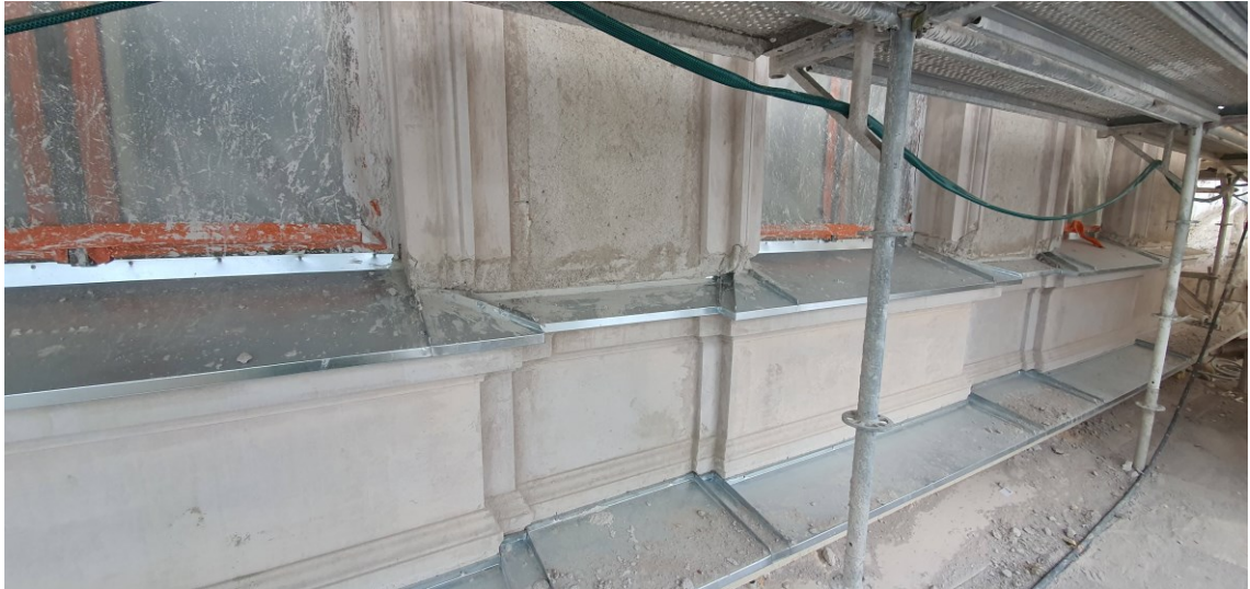
Kuva 23. Koriste- ja pintarapattu seinä, sekä laastilla hapotetut pellit.
