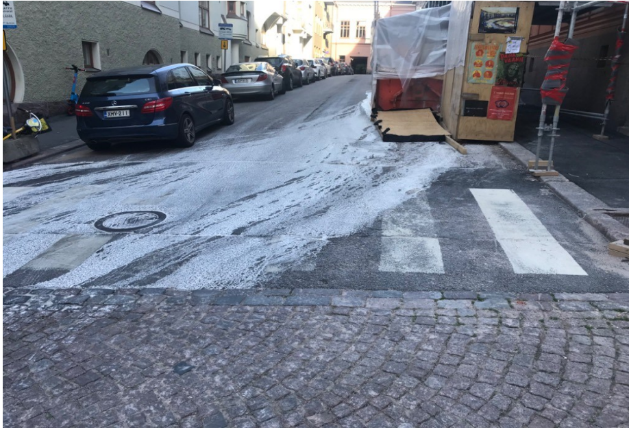
Kuva 18. Huonosti tiivistettylaastiaseman kalkkivesi valunut kadulle.
