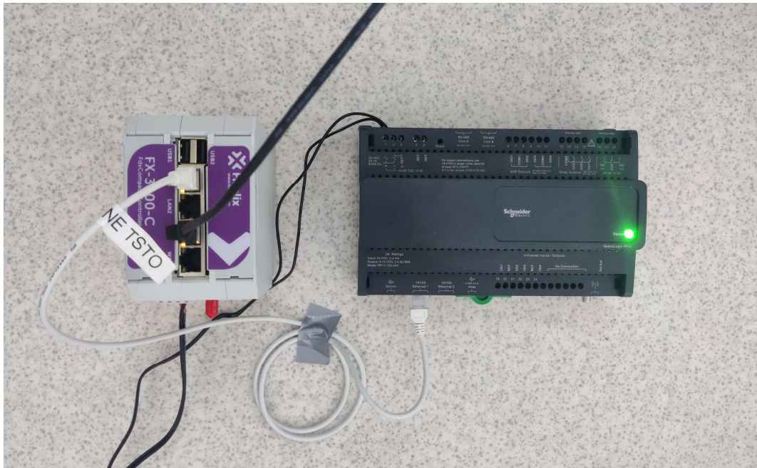
Kuva 6. Fidelixin keskusyksikkö ja RP-C yhdistettynä Ethernet-kaapelilla
