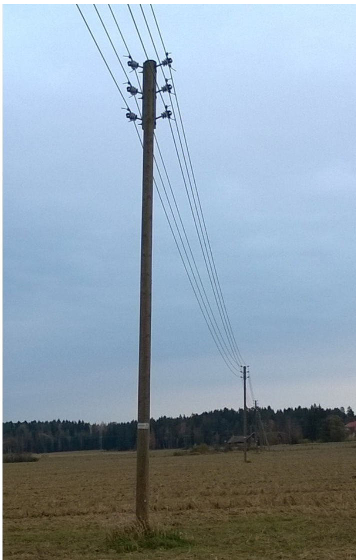
KUVA 4. Kaksois-PAS-johto säävarmalla paikalla (Niemi 2014-10-7.)
