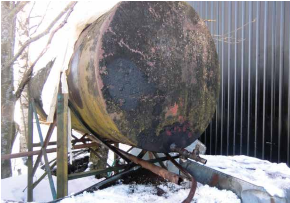
Kuva 12. Traktori peruutti farmarisäiliön hanaan. Putkirikosta aiheutui öljyvahinko. (Kanta-Hämeen pelastuslaitos 2013)
