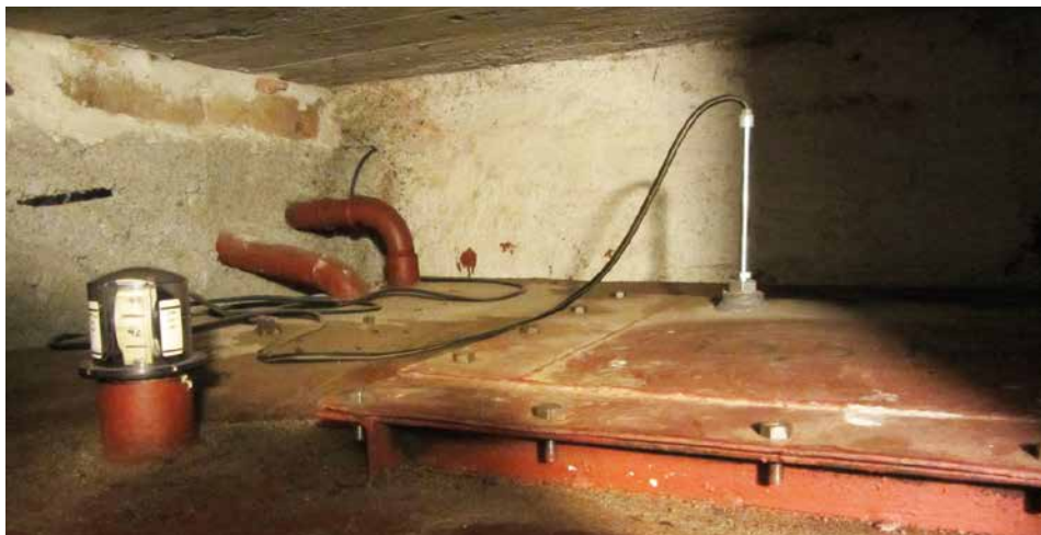
Kuva 1. Kellariin sijoitettu metallisäiliö: ylitäytönestimen anturi on kiinnitetty huoltoluukkuun. (Teija Tohmo 2013)
