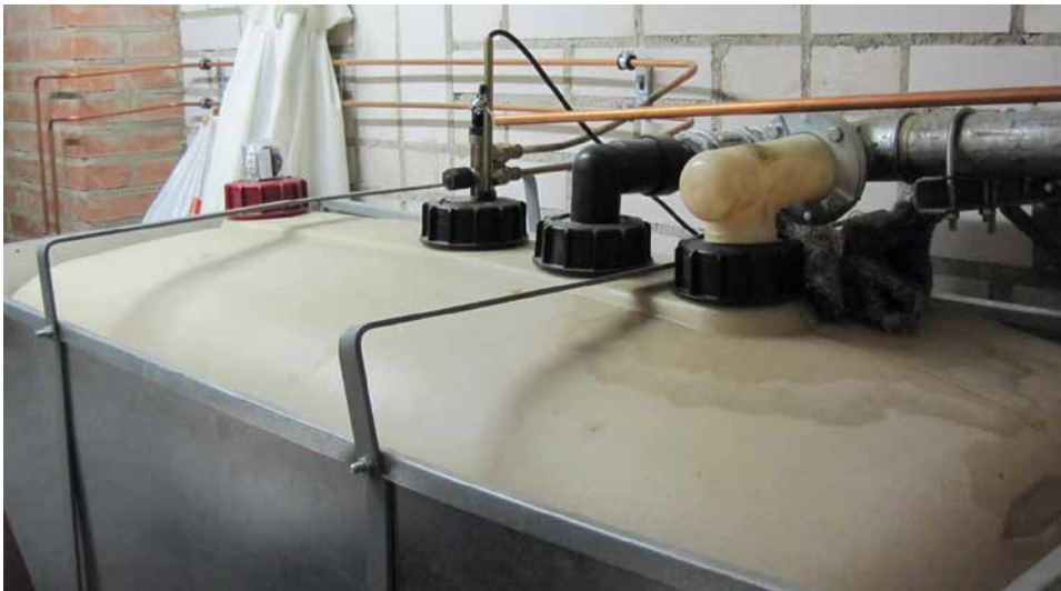
Kuva 6. Sisään sijoitettu muovisäiliö metallisessa suoja-altaassa. (Tarja Asikainen 2013)
