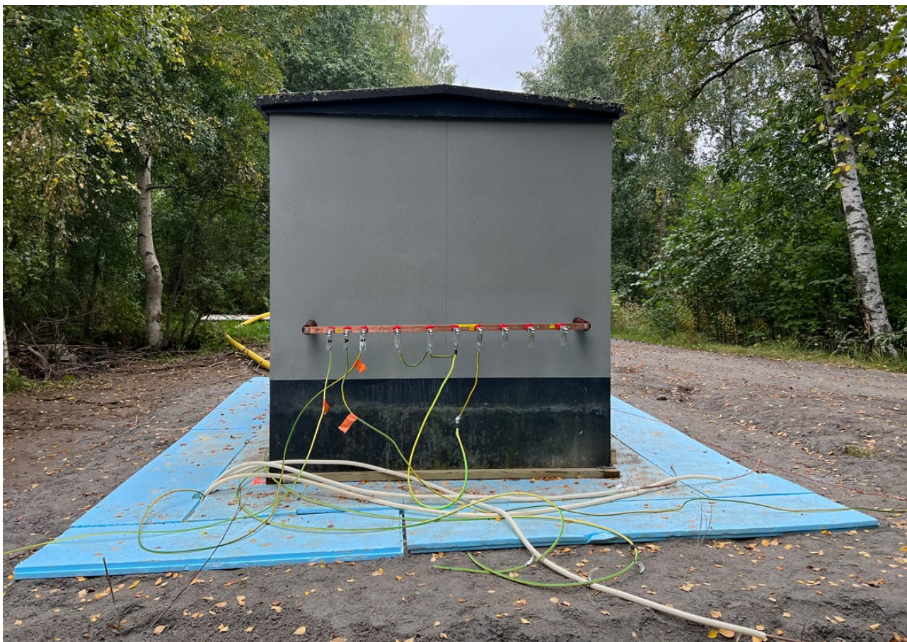
Kuva 3. Testimuuntamo eristetyllä alustalla. Muuntamoon tulevat maadoitukset on kerätty eristettyyn maadoituskiskoon. Kuva on otettu rakennusvaiheessa, jolloin kaikki maadoitukset eivät vielä olleet kytkettyinä.
