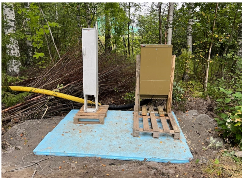
Kuva 6. Kosketusjännitemittauksissa hyödynnetyt jakokaapit, joissa U_T ja U_{VT} -mittauselektrodit on toteutettu maapiikin avulla jakokaapin taakse
