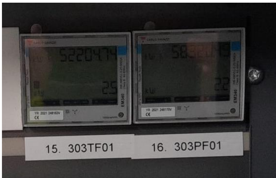
Kuva 10. Asennetut Carlo Gavazzi EM340 energiamittarit.
