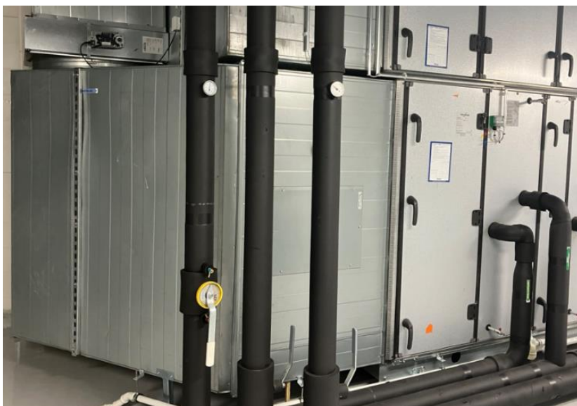
Kuva 18. TK306-TF01 tuloilmakoneen raitisilmakanava ja tuloilmakammio
