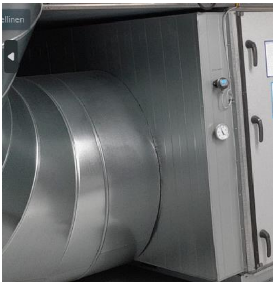
Kuva 16. TK303-TF01 raitisilmakanavan suunnitelmien vastaisesti toteutettu liitännä tuloilmakammioon ja kavennettu tuloilmakammio.
