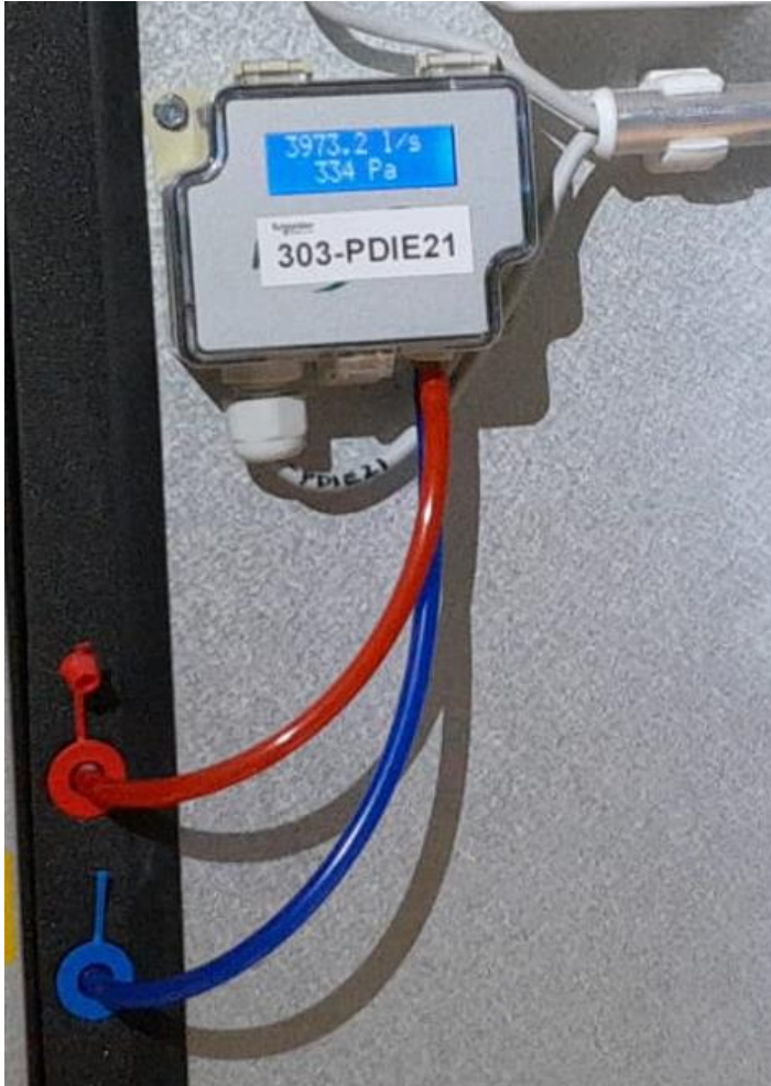
Kuva 8. Ilmamäärämittauksessa käytetty esiasennettu Fläktwoods DPT7000-D-F paine-erolähetin.
