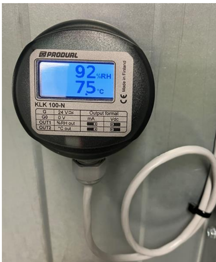
Kuva 11. Asennettu Produal KLK 100-N lämpötila- ja kosteuslähetin.
