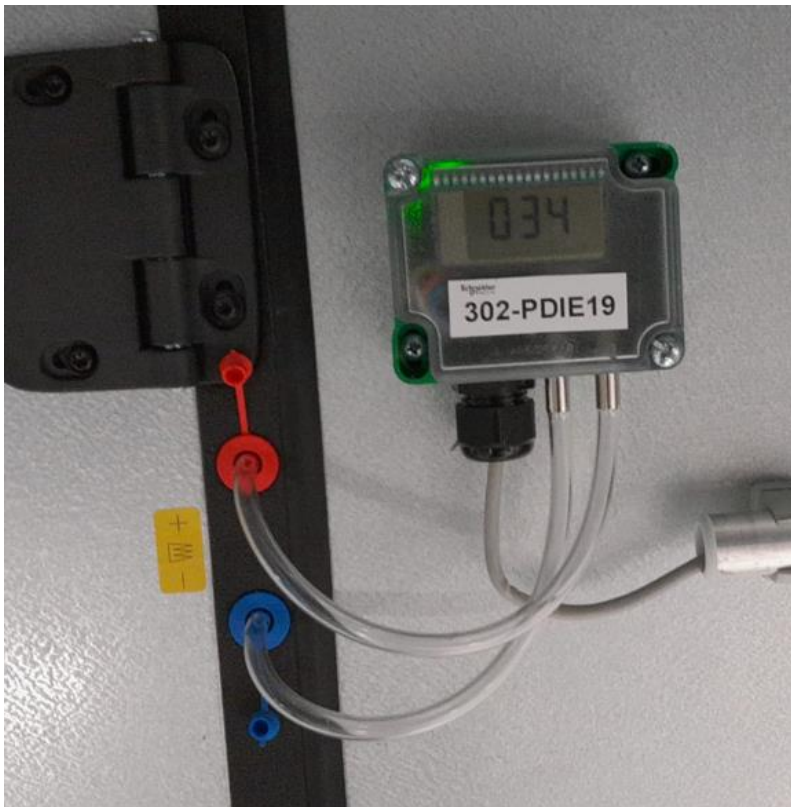
Kuva 9. Suodattimen paine-eromittauksessa käytetty esiasennettu Schneider Electric SPD360-300 paine-erolähetin.
