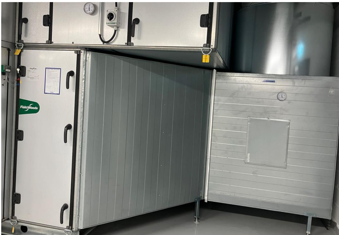
Kuva 15. Suunnitelmien vastaisesti toteutettu TK302-TF01 tuloilmakoneen rai- tisilmakanava ja tuloilmakammio.
