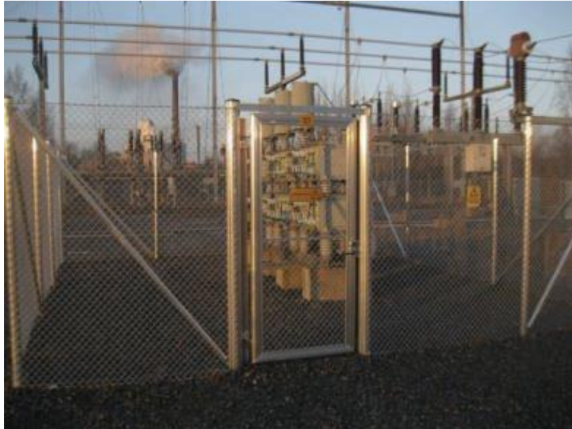
Kuva 28. Kompensointilaitteisto (4,8 Mvar) löytyy ulkokentältä
