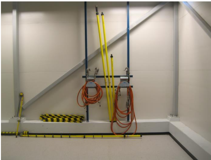
Kuva 26. Maadoitus- ja koestusvälineitä kojeistotilan päädyssä
