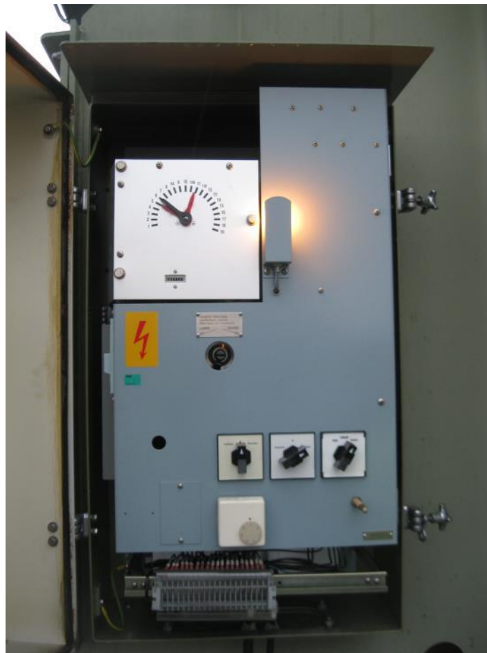
Kuva 39. PM1:sen käämikytkimen ohjainkotelo avattuna. Oikealla alakulmassa osoitin, automaatti/käsikäyttökytkimet sekä lämmitystermostaatti.
