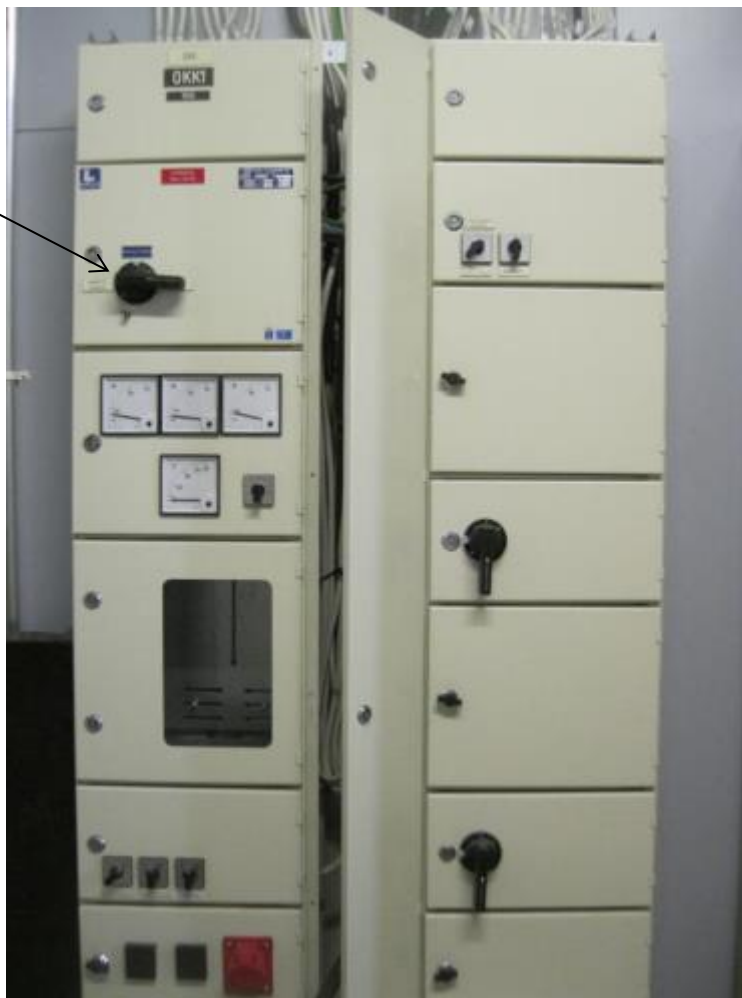
Kuva 2. Omakäyttökeskus varustettuna vaihtokytkimellä, jolla voidaan vaihtaa keskuksen sähkönsyöttöä
