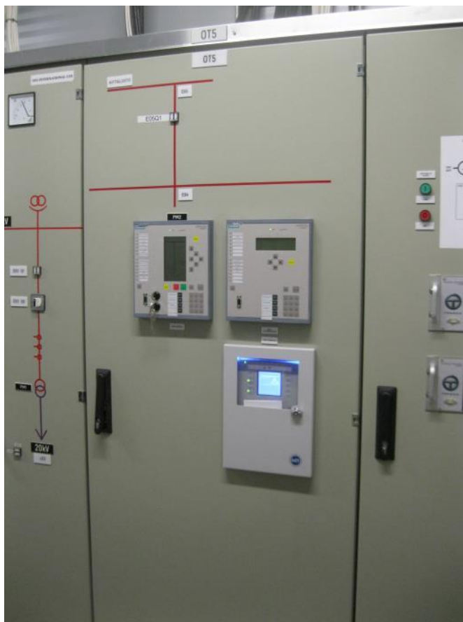
Kuva 18. PM2:sen kennotermiinaali (vas. ylhäällä) , vara/differentiaalisuoja (oik. ylhäällä) ja jännitteensäätäjä
