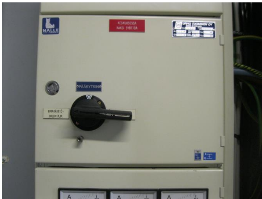
Kuva 3. Omakäyttösähkön pääkytkin lähempää kuvattuna
