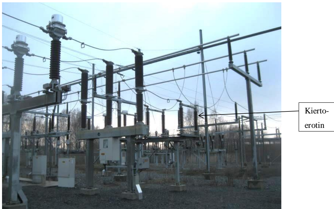
Kuva 19. Yleisnäkymä komponenteista PM2:sen jälkeen. Etualalla virtamuuntaja, tämän jälkeen katkaisija ja kiertoerotin
