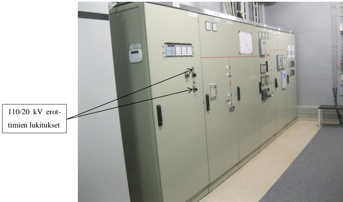
Kuva 14. 110 kV:n ohjaustaulu aseman valvomotilassa
