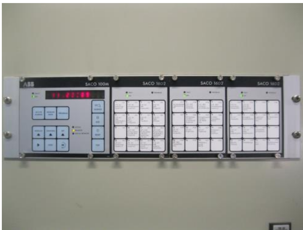
Kuva 40 Hälytyskeskus SACO 148D4. Asemavalvomon kojeistossa OT1. SPA-väylä ja kaukokäyttöön liittyvä modeemi kojeiston sisällä.
