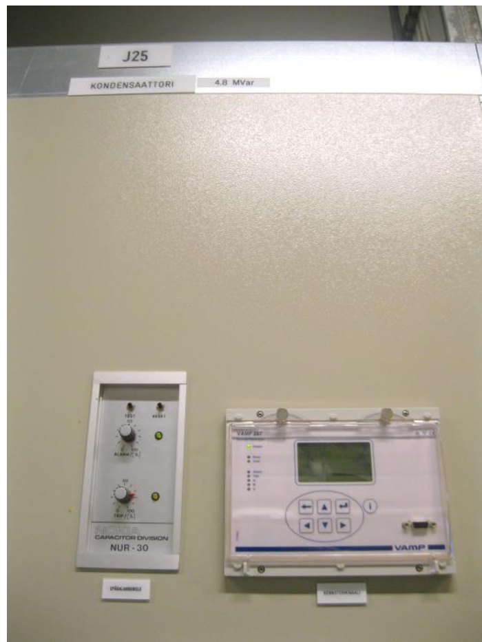
Kuva 29. Loistehosujauksen kondensaattorin epäbalanssirele (vas.) ja kennoterminaali (oik.)
