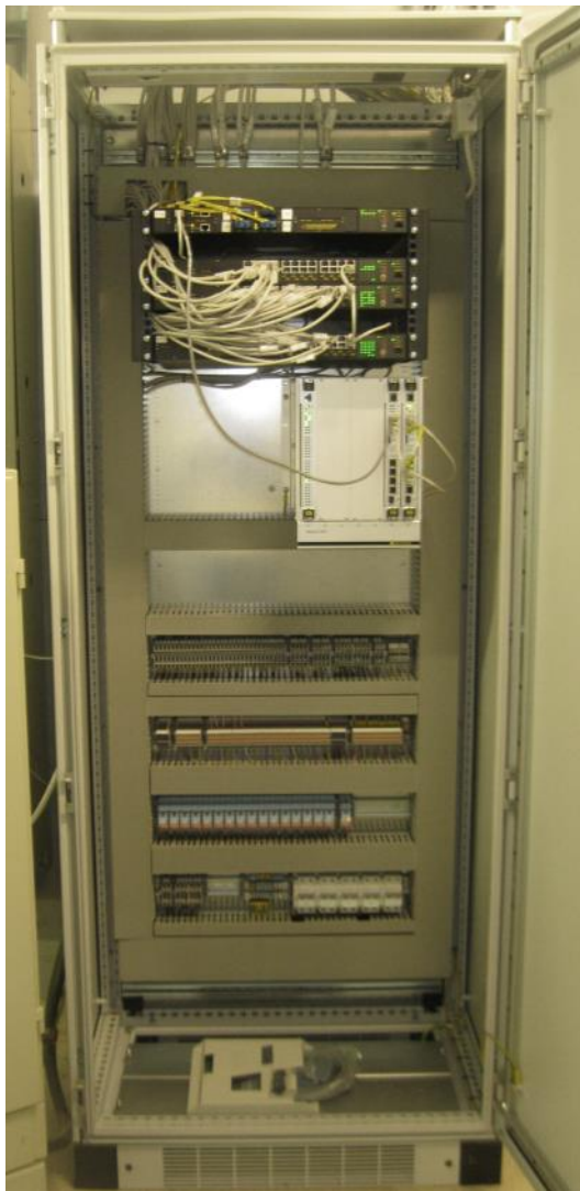
Kuva 8. Kaukokäyttöjärjestelmän ohjauskaappi Netcontrol. Tyyppi Netcon 500
