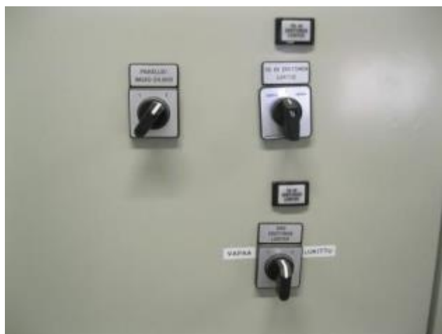
Kuva 22. Asemavalvomon erottimien lukituskytkimet osassa OT1. OT1:ssä sijaitsee myös kaukokäytön estävä paikalliskytkin.
