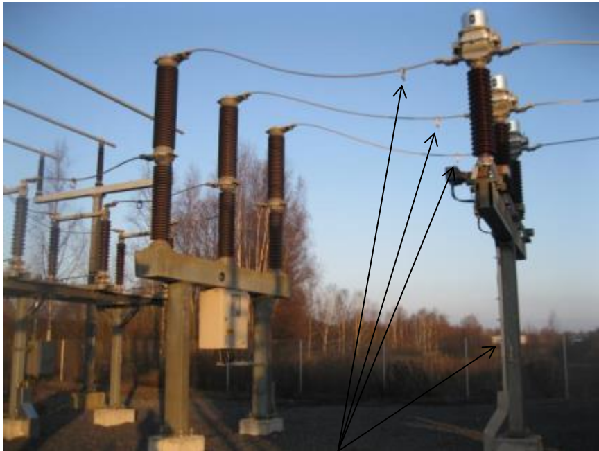
Kuva 24. Mahdollisia maadoituspaikkoja esim. työskenneltäessä PM2:llä. Oikealla virtamuuntajat ja vasemmalla katkaisijapilarit.
