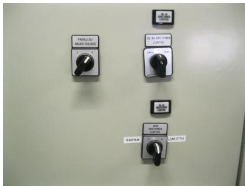
Kuva 13. Kuva valvomotilan OT1:stä, josta löytyvät mm. 20 kV:n ja 110 kV:n erottimien lukitusten vapautuskytkimet sekä kaukokäytön estokytin
