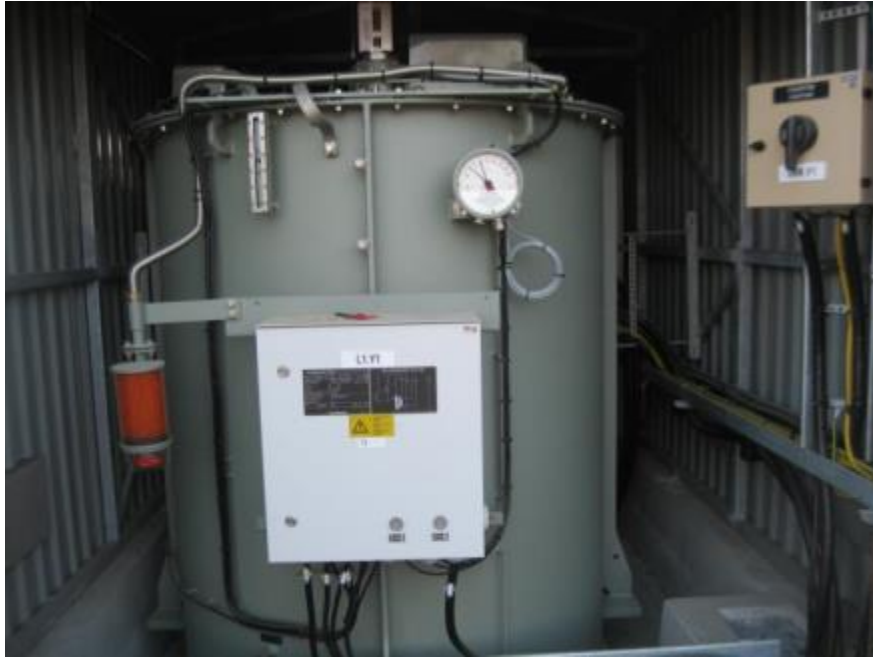
Kuva 33. Sammutuskuristin, joka sijaitsee samassa tilassa kuin tähtipistemuuntaja
