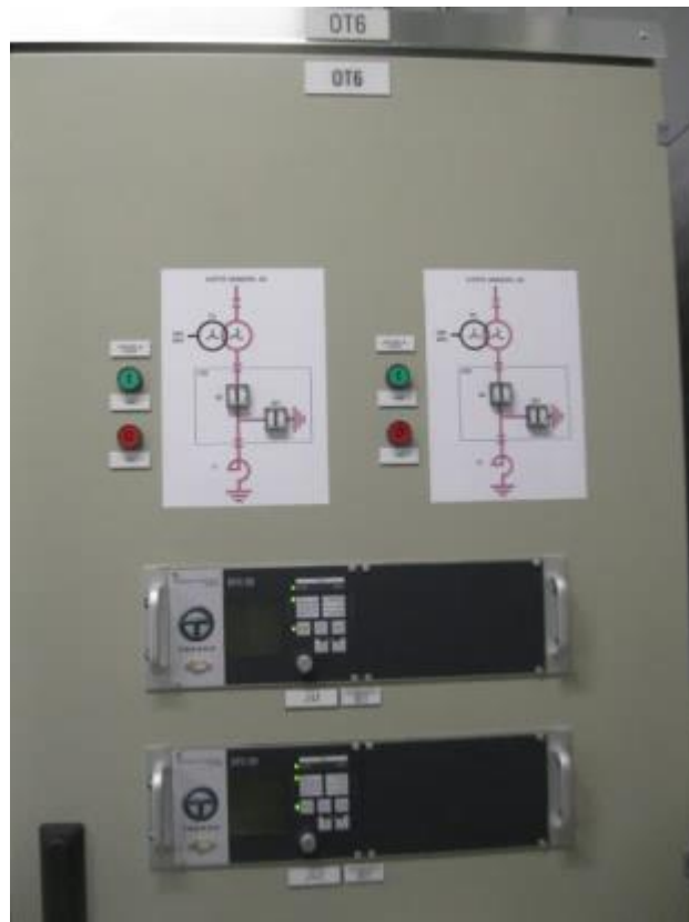
Kuva 31. Kompensointikelan säätäjät (EFC 50) sähköaseman valvomotilan taulussa OT6
