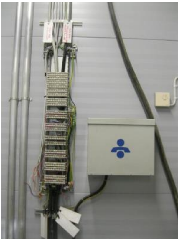
Kuva 7. Aseman päälaiteteline valvomotilassa
