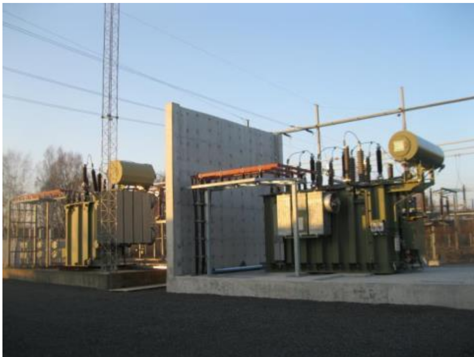
Kuva 35. Päämuuntajat PM1 (vas.) ja PM2 (oik.). Muuntajien päällä näkyvät ylijännitesuojat, jotka ovat asennettu päämuuntajien eristettyihin tähtipisteisiin.
