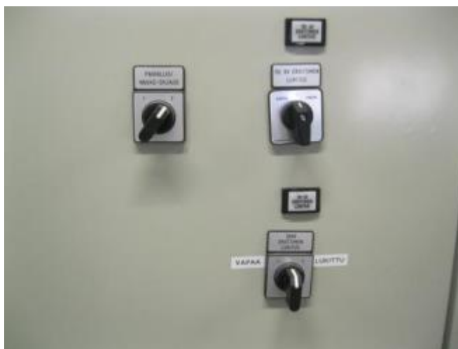
Kuva 9. Paikallis/kaukokäyttökatkaisija vasemmalla (OT1)
