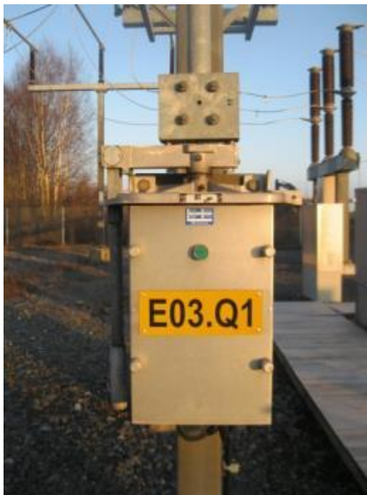
Kuva 21. Erottimen (E03.Q1) ohjauskotelo ohjauskampineen
