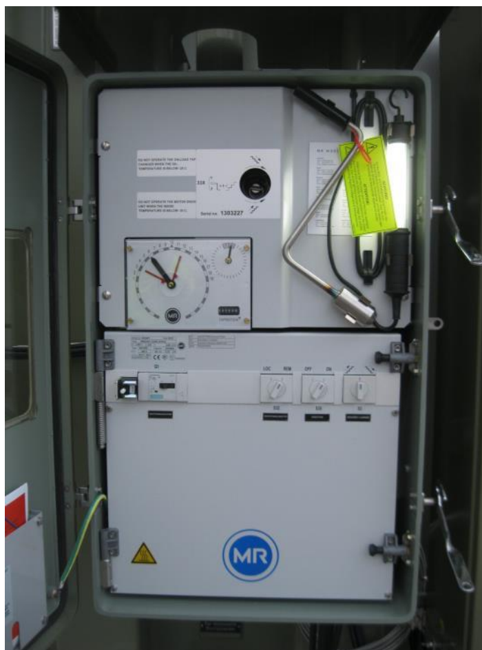
Kuva 37. PM2:sen käämikytkimen ohjainkotelo. Kytkimet kauko/paikalliskäytölle, pääkytkimelle ja nousee/laskee osoittimelle.
