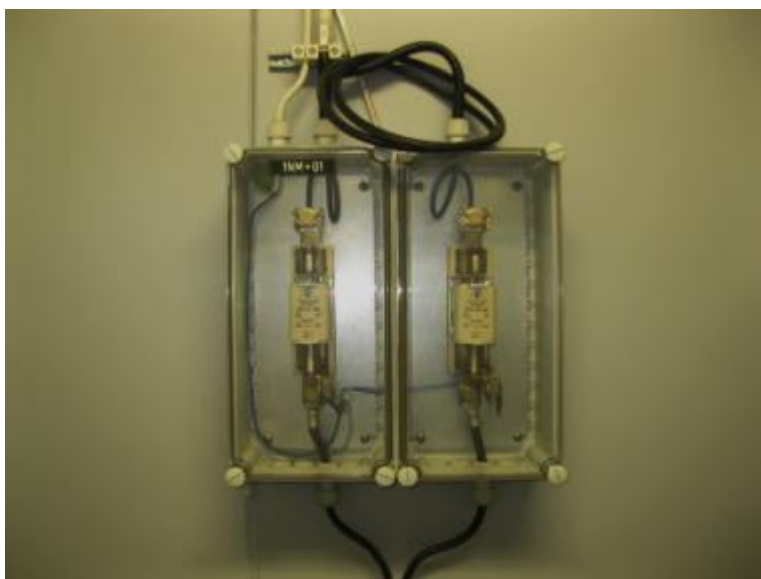
Kuva 6. 110 V:n akuston päävarokkeet varustettuna hälytyskoskettimilla
