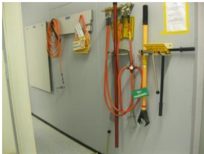
Kuva 25. Maadoitusvälineitä kojeistotilassa heti tullessa aseman valvomotilasta
