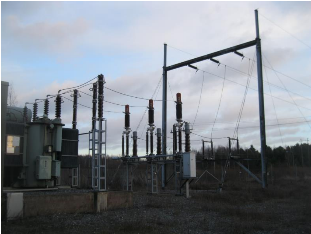
Kuva 2. Kuva Ulasoorin sähköasemalta
