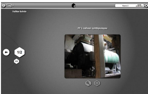
Kuva 8. Ensimmäinen alue: Pp 1:n pumpun moottori
