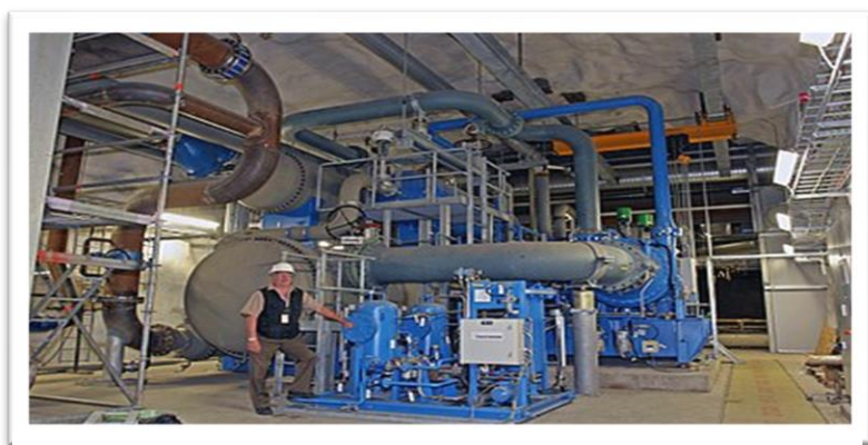
Kuva 2. Katri valan lämpöpumppulaitos. (3).
