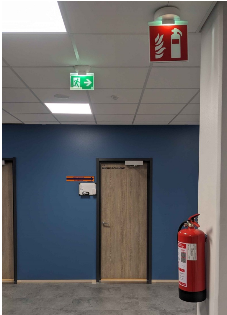
Kuva 2. Käsisammutin-, poistumistie- ja väestönsuojan opasteet Pohjois-Savon pelastuslaitoksen Petosen paloasemalla
