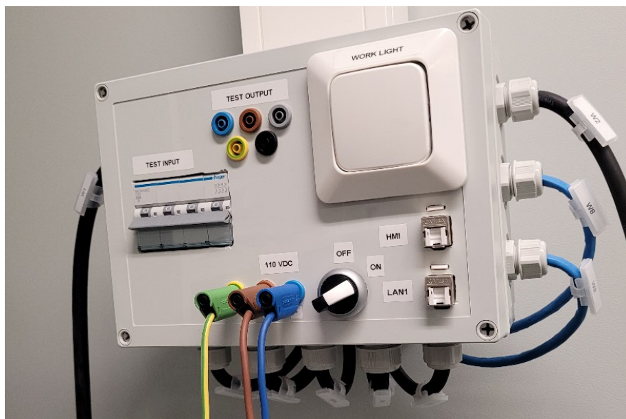
Kuva 13. Liitäntäalusta toimiva asennuskotelo, nollavaihe ei mene kojeiston sisään.
