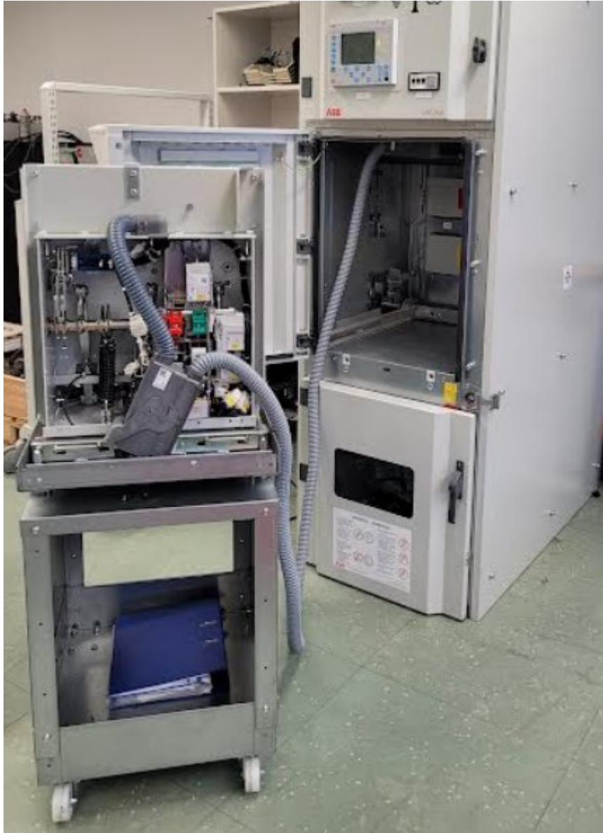
Kuva 20. Katkaisija ulkona vaunussa, jatkokaapeli kiinnitettynä ja etukuori poistettuna.
