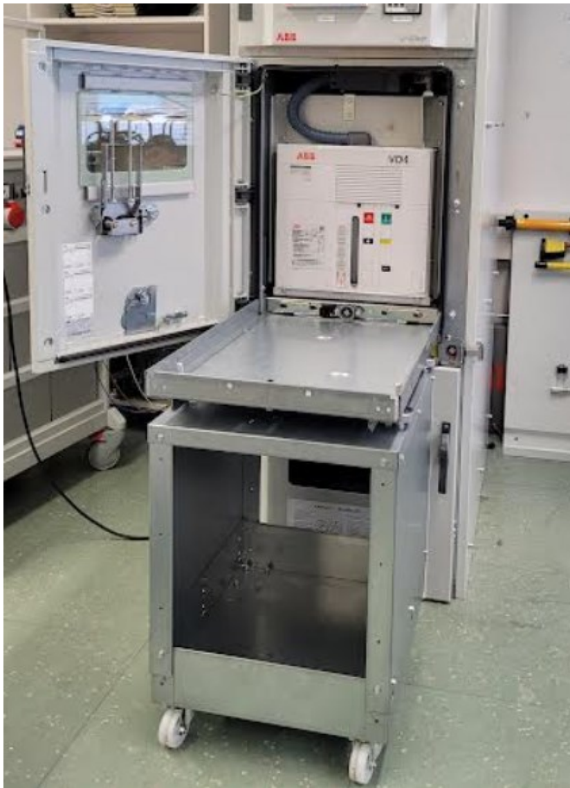
Kuva 5. Opetuskojeiston katkaisija testiasennossa, pääkojetilan luukku auki ja kuljetusvaunu paikoillaan.
