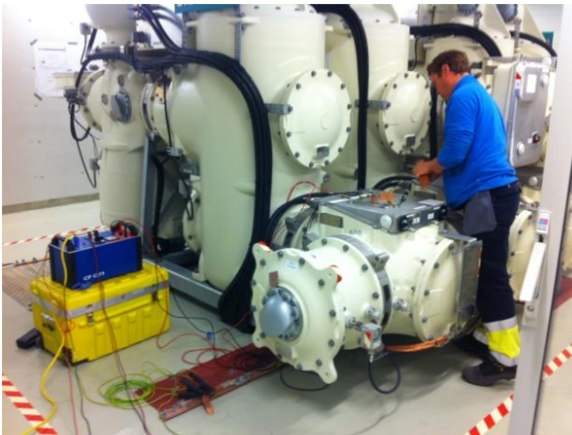
Kuva 26. Kaasueristeinen 110 kV kytkinlaitos (Siemens). Impedanssimittausten valmistelut käynnissä.
