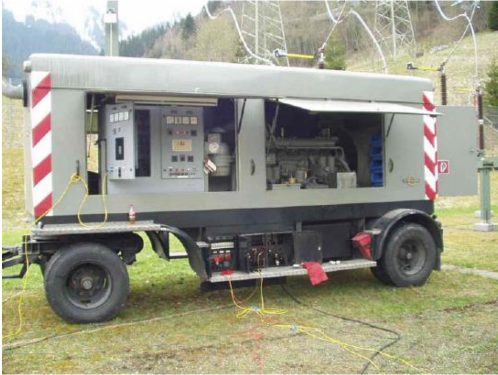
Kuva 13. Tyypillinen varavoimakone (300 kVA) [29]
