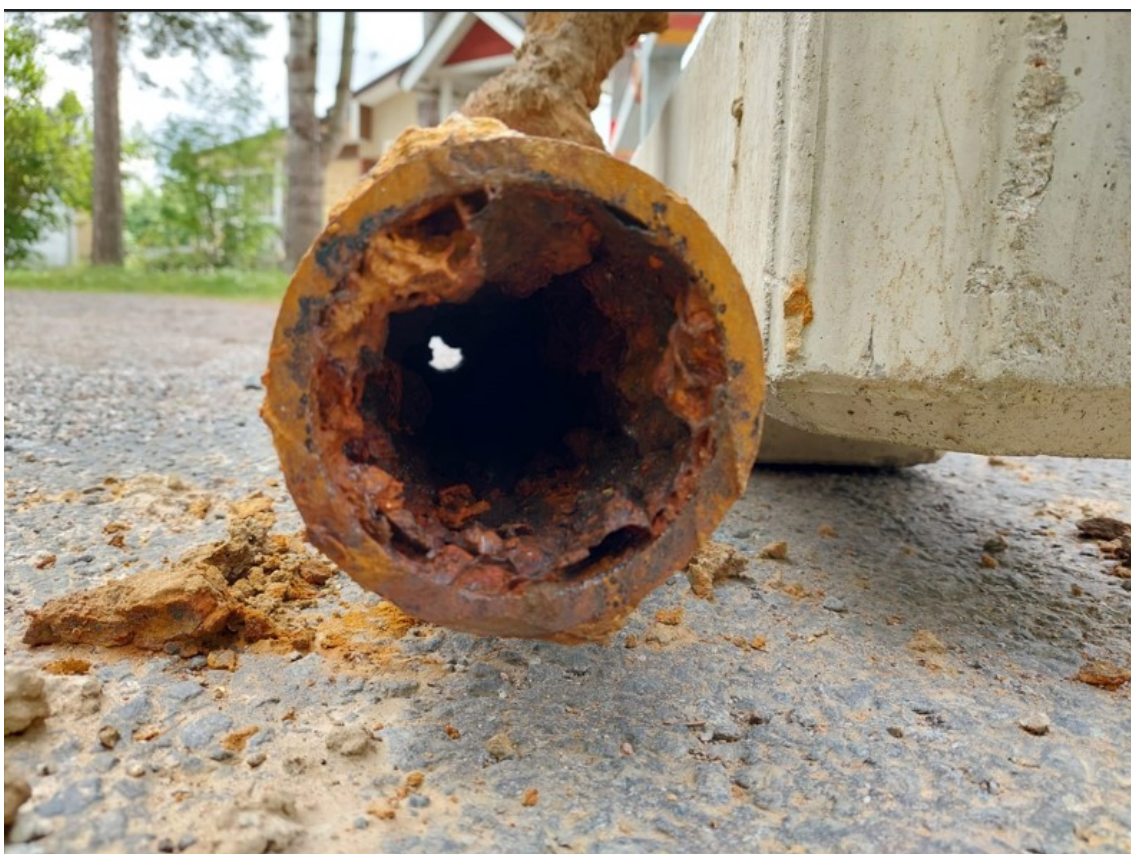
KUVA 2. Vanha saneerauksen yhteydessä käytöstä poistettu valurautainen vesijohto (Ylöjärven Vesi Oy)
