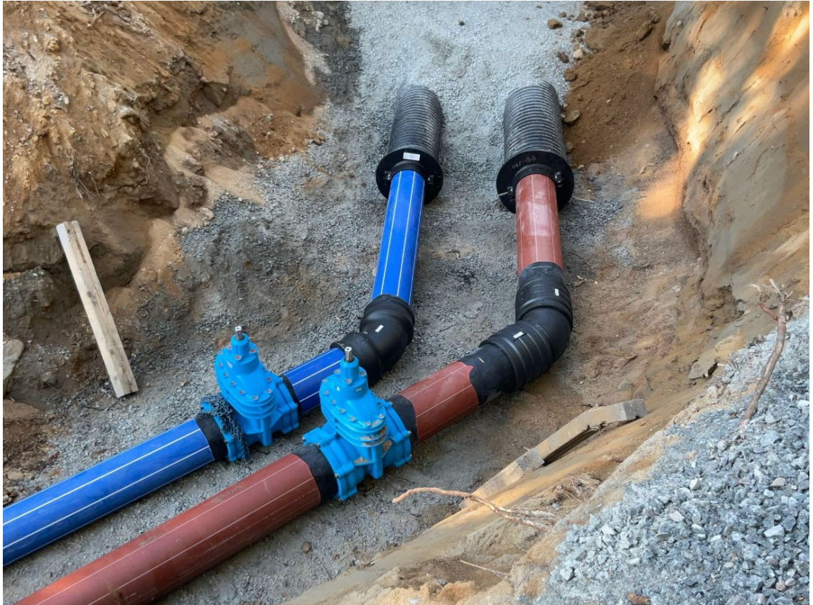
KUVA 1. Vesijohto 250 mm PEH PN 10 (sininen) ja Paineviemäri 280 mm PEH PN 10 (ruskea) sekä hawle kumiluistinventtiilit. (Ylöjärven Vesi Oy)
