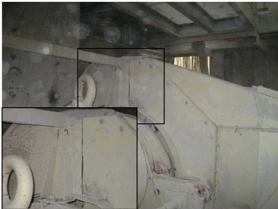
Kuva 10 Vauhtipyöränsuojan takalevy haljennut molemmilta puolilta
