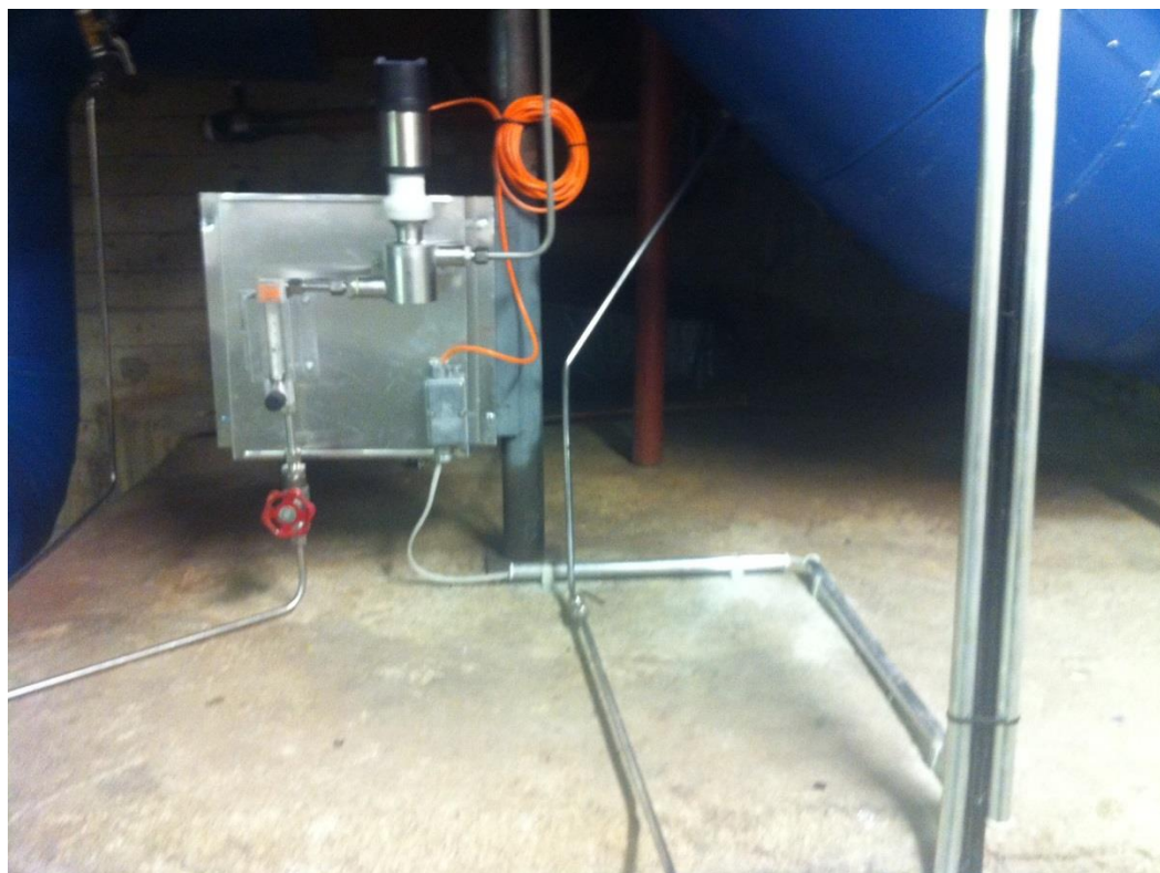
KUVA 17. Johtokykymittaus ja asennuslevy asennettuna Harjulan pumppaamolla (valokuva Iiro Karppinen.)
