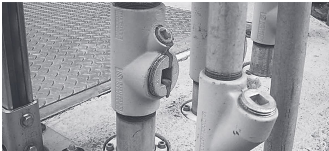
Kuva 14. Tyypilliset kaapeleiden suojaputkiin asennetut tiivisteliittimet (Emerson 2023, 70)
