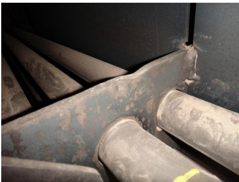
Kuva 19. Sekundääriluvo 3 putken 16 eroosiokorroosio. (Valmetin tarkastusraportti 2014)
