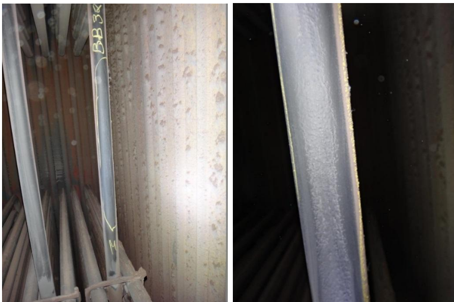
Kuva 17. Kantoputken 32 eroosiota nuohouslinjalla 9. (Valmetin tarkastusraportti 2014)
