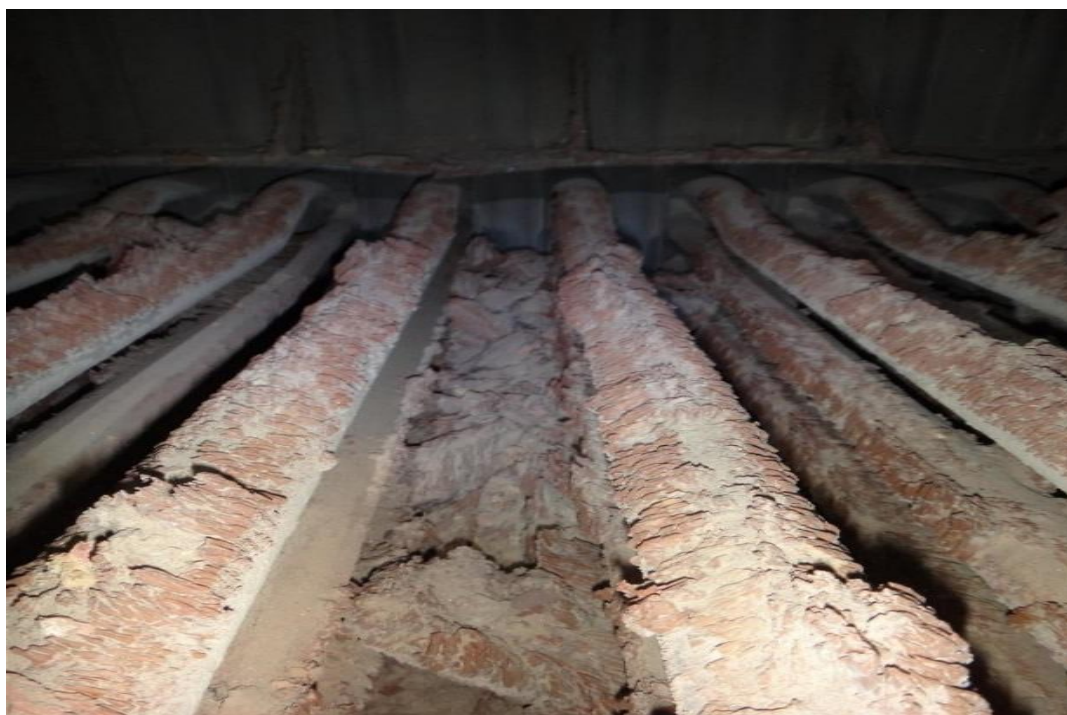
Kuva 12. Toisen primääritulistimen keskialueen yläosassa takaseinän läheisyydessä oleva kerrostuma. (Valmetin tarkastusraportti 2014)
