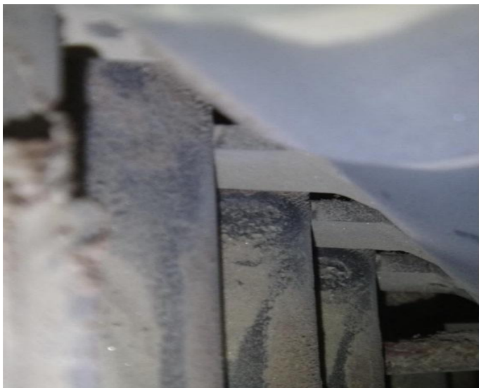
Kuva 14. Nuohoimen 5 alapuolella olevan kolmannen elementin 5 ja 6 putki. (Valmetin tarkastusraportti 2014)
