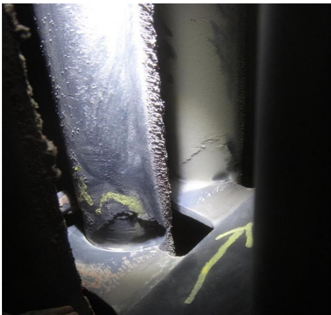
Kuva 13. Elementti 1, toiseksi alin putki nuohoimen 5 yläpuolella. (Valmetin tarkastusraportti 2014)
