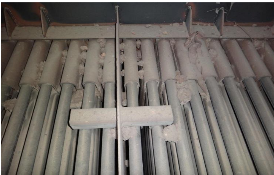
Kuva 18. Kolmannen ekonomaiserin keskialueen tuhka- ja tikkimateriaalin tukkimia takaseinällä. (Valmetin tarkastusraportti 2014)
