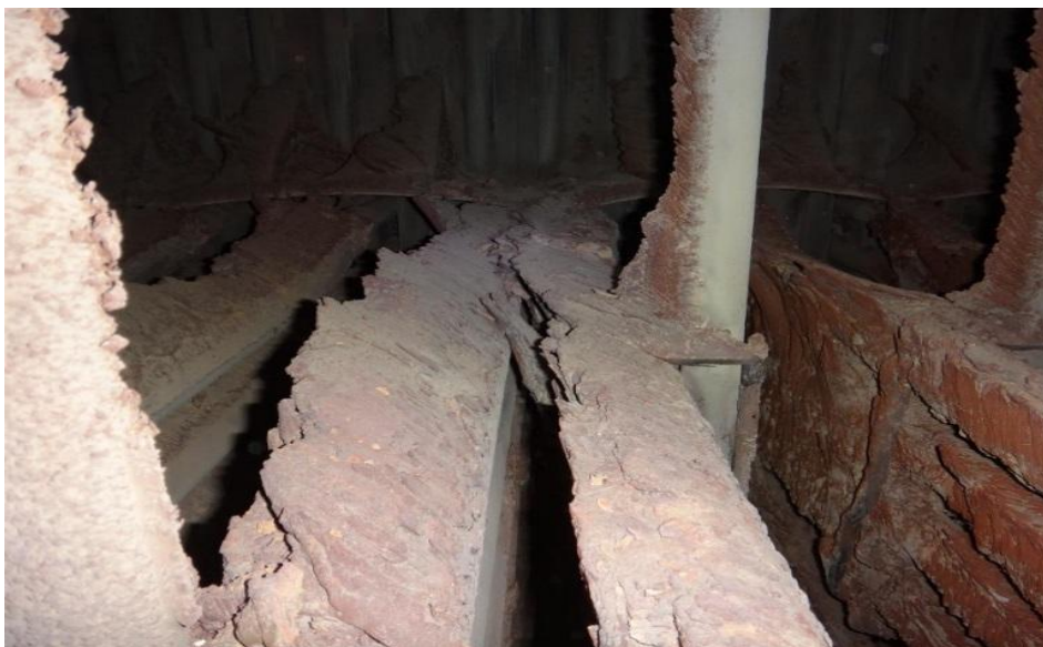
Kuva 15. Kerrostumaa sekundääritulistimen takaseinän puolella. (Valmetin tarkastusraportti 2014)
