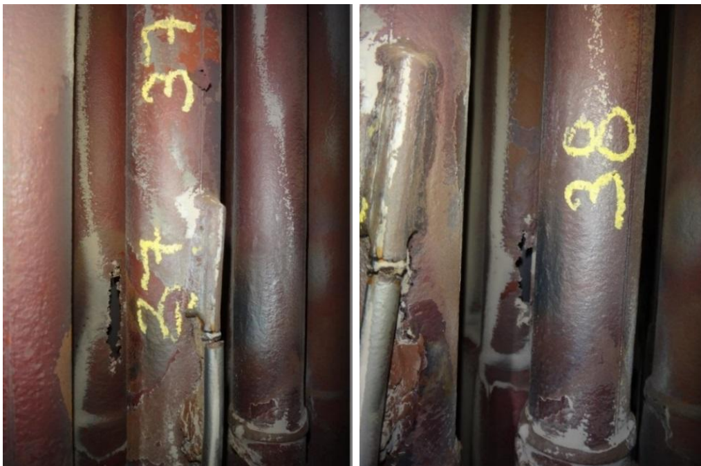
Kuva 20. Ensimmäisen primääriluvon kylmänpään rivin 37 ja 38 vaurioita. (Valmetin tarkastusraportti 2014)
