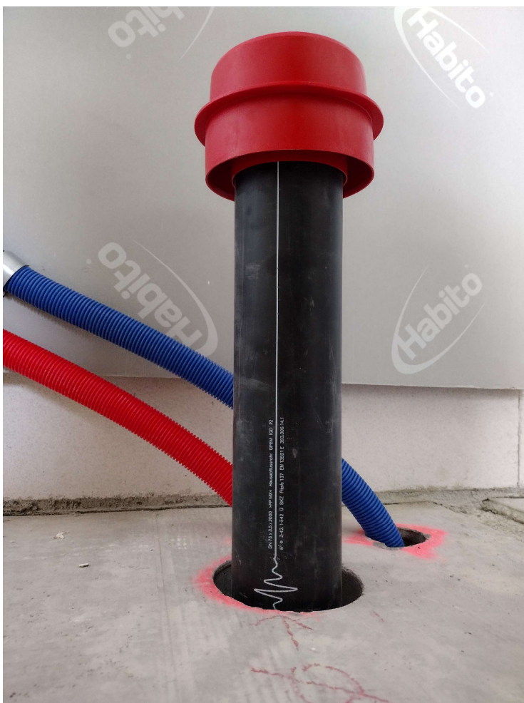
KUVA 14. Ääntä vaimentava viemäriputki.
