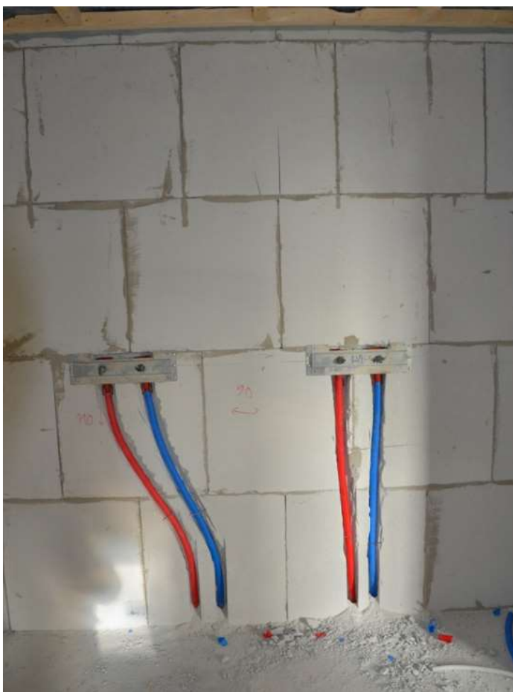
KUVA 5. Vesiputkien roiloitus (Nonni, porattiin vesiputkeen 2011)
