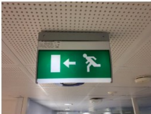
Kuva 17 4 TIETOTEKNISET JÄRJESTELMÄT T5 Tilaturvallisuusjärjestelmä
