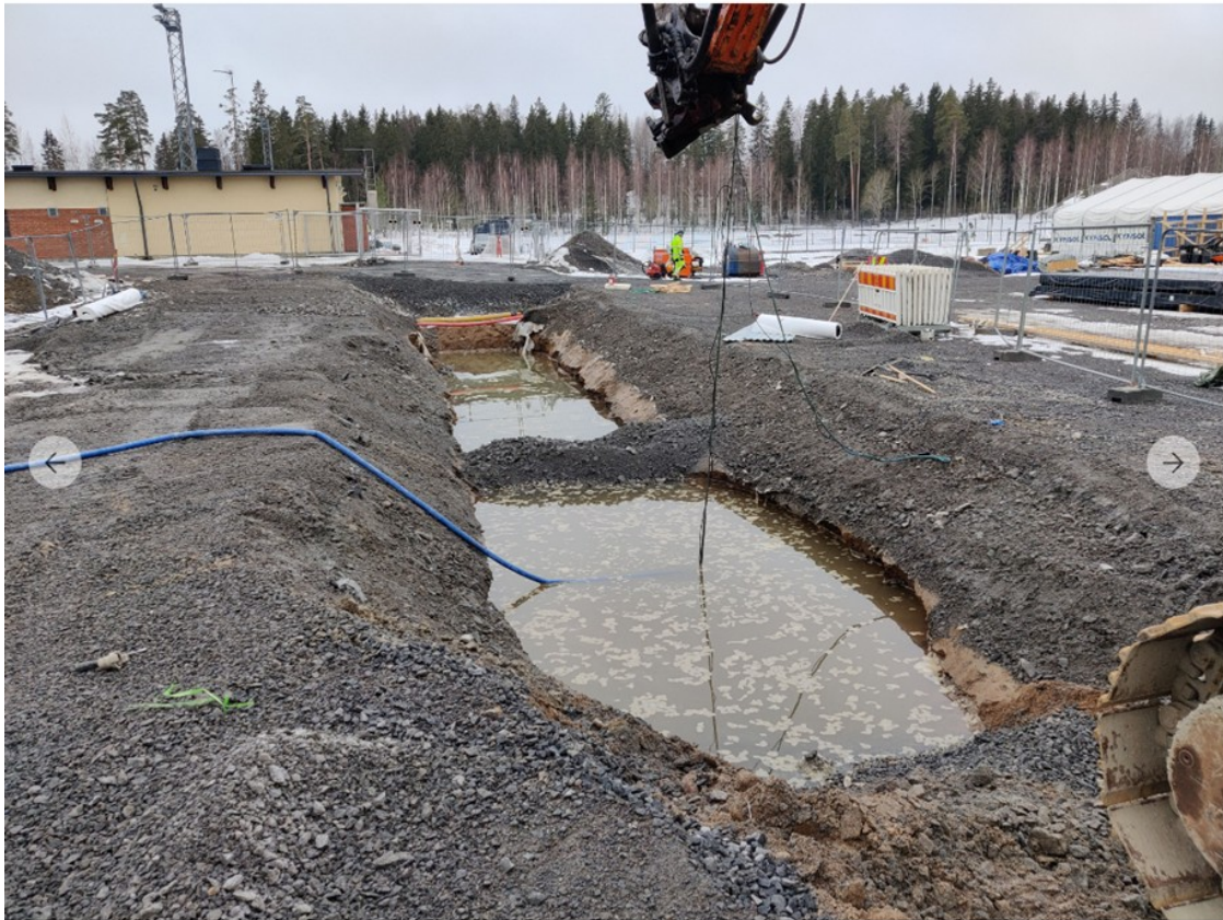
Kuva 9. vedellä täyttynyt kaivanto (Maija Karhu, 2023)
