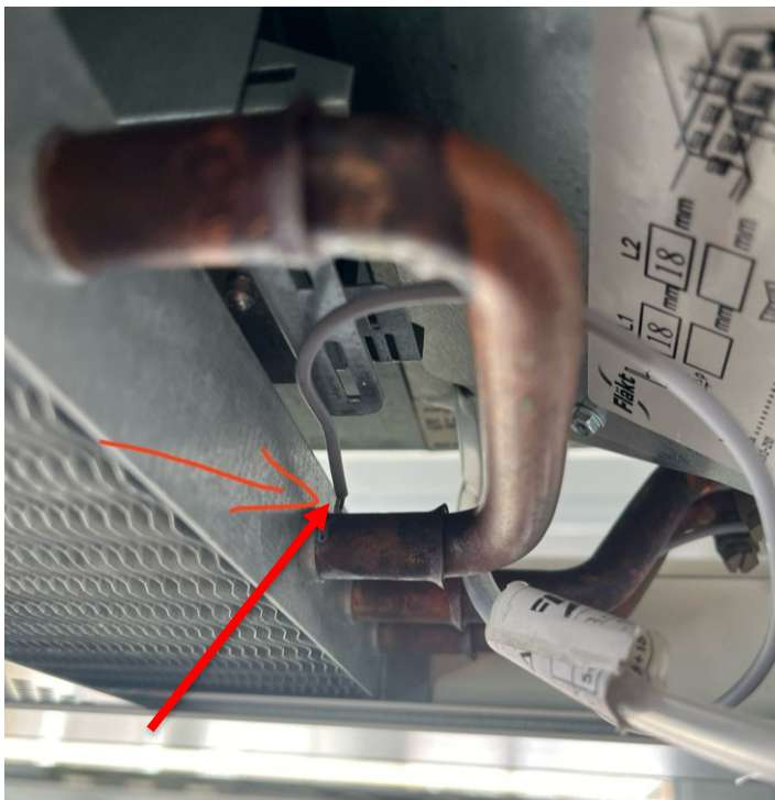
Kuva 12. Huoneanturin pääte-elin oli sijoitettu aktiivipalkin kupariputken päälle.
