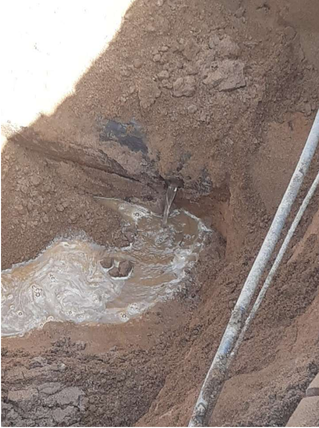
Kuva 2. Palovesilinjan vuoto (Kuva: Joni Lemmetyinen 2025)
