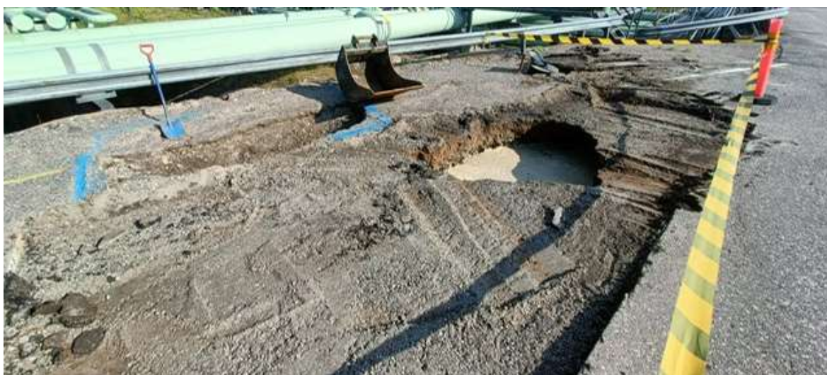
Kuva 1. Palovesilinjan vuoto (Kuva: Joni Lemmetyinen 2025)
