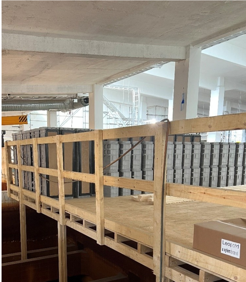
Kuva 6. Puinen työtaso sekä putoamissuoja
