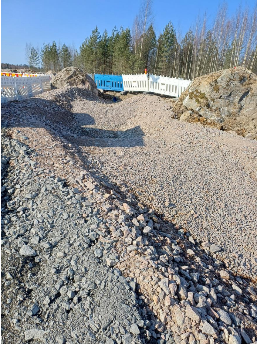
KUVA 9. Koururakennelma, jota pitkin vesi valuu viivytysaltaaseen suotopatojen läpi (Ala-Hiiri).
