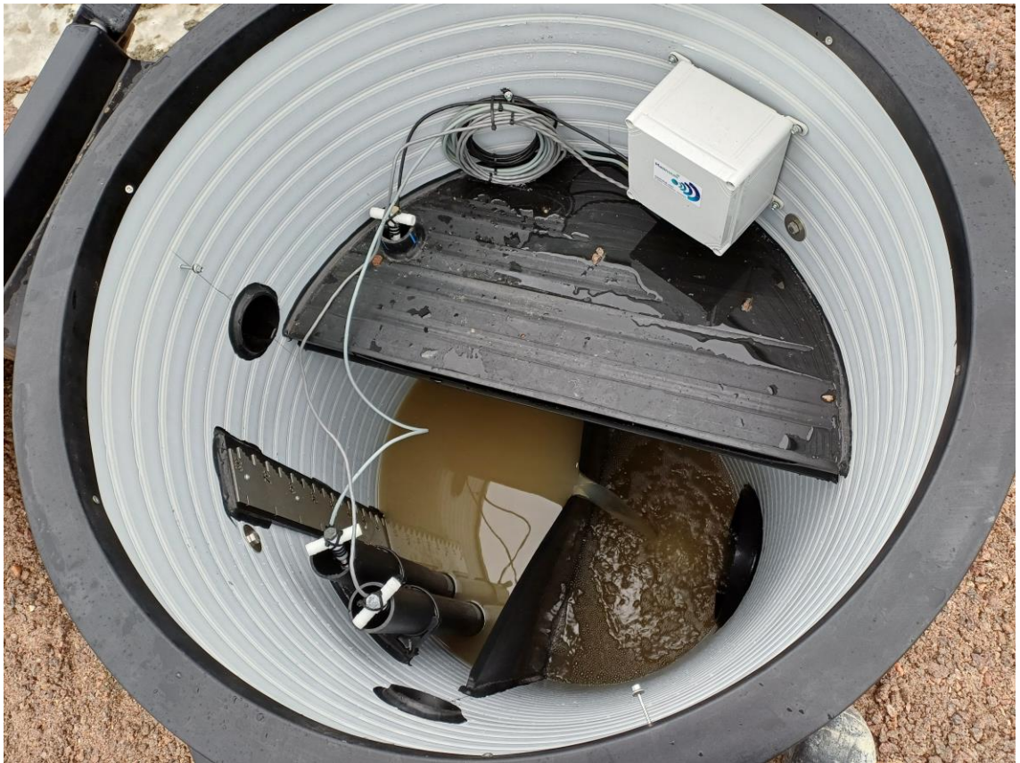
KUVA 23. Sisäpuolinen kuva mittakaivosta (Ala-Hiiri).
