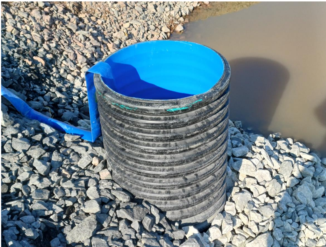
KUVA 10. Pumppukaivo, josta vesi pumpataan letkua pitkin saostuslavalle (Ala-Hiiri).
