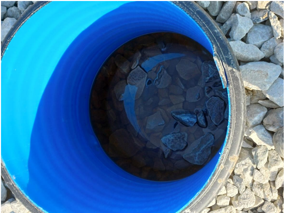
KUVA 11. Pumppukaivon sisäpuoli ilman uppopumppua ja letkua (Ala-Hiiri).
