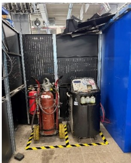
Kuva 17. Ilmastointilaitte ja kaasupoltin uudelleen järjestettynä.
