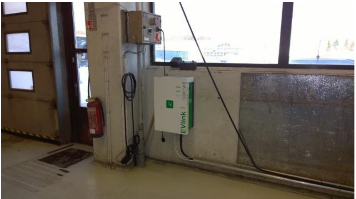
KUVA 1. Korjaamon sisäseinään on asennettu kiinteä latausasema sähköautoille.
