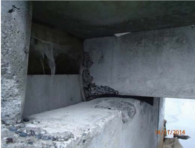
KUVA 24. Palkkien päädyssä on lohkeamia
