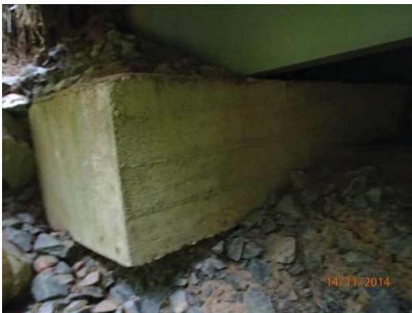
KUVA 8. Maatuen alta on syöpynyt maa-ainesta
