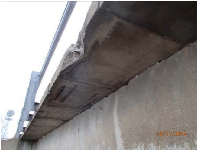
KUVA 21. Kansilaatassa on iso lohkeama ja raudoitukset näkyvissä
