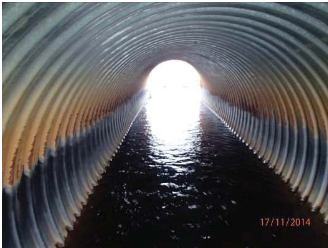
KUVA 34. Toisella käynnillä vedenpinta oli laskenut huomattavasti
