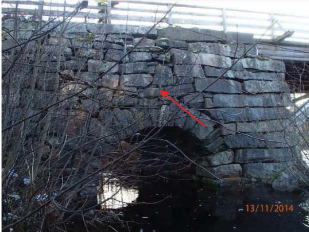
KUVA 43. Tuen 2 kiviholvisillassa on erittäin vakavia kivien siirtymiä
