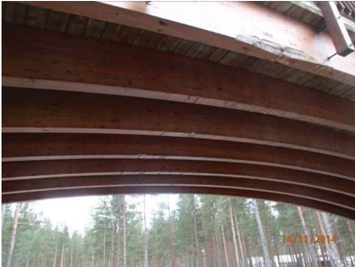
KUVA 37. Pohjoisemman latusillan törmäysvaurio
