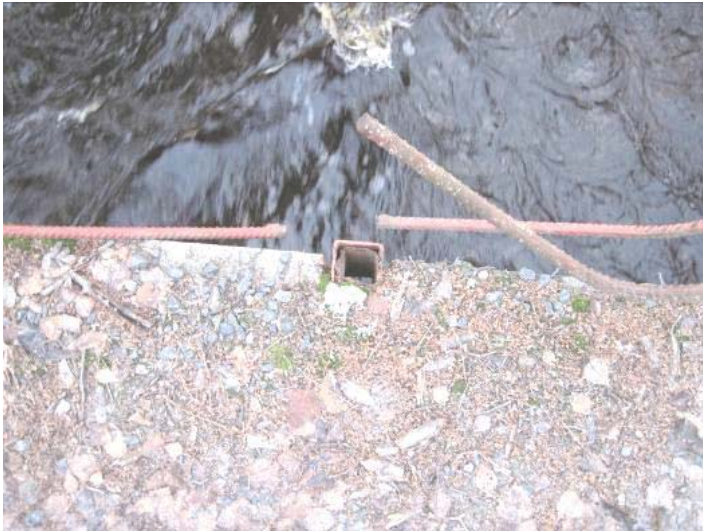
KUVA 16. Yksi kaidepylväs on irti
