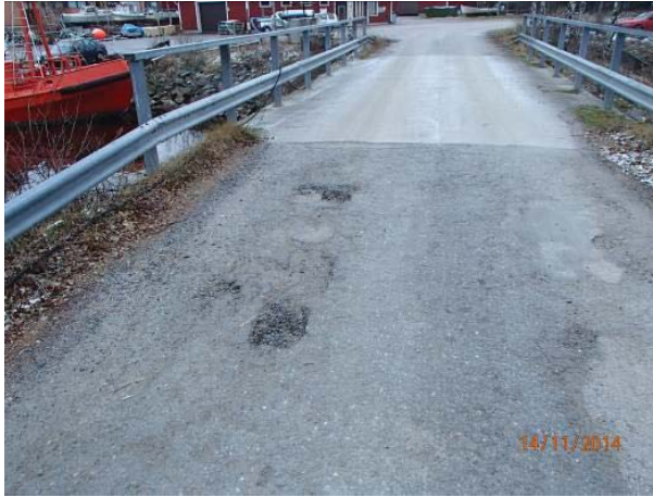
KUVA 28. Tulopenkereen päällysteessä on purkauksia
