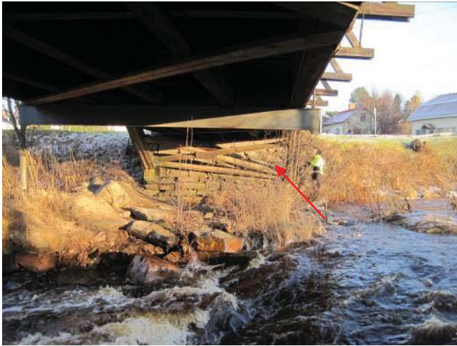
KUVA 39. Pohjoisemman raittisillan toinen maatuki on painunut reunalta
