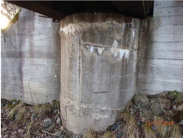
KUVA 9. Koulusillan maatuen 1 halkeiluvauriot
