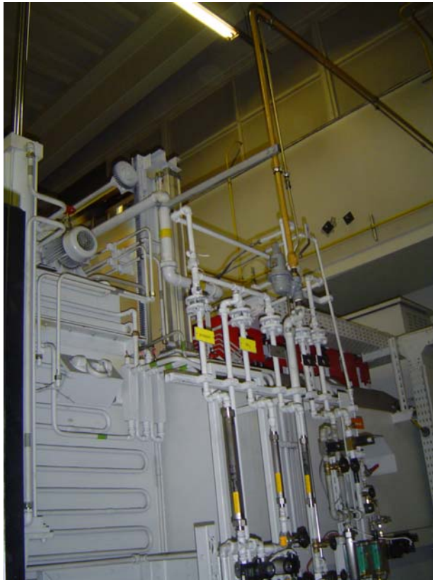
Kuva 11. Hiiletyskarkaisu-uunin oikealla seinällä sijaitsee kaasupaneeli.
