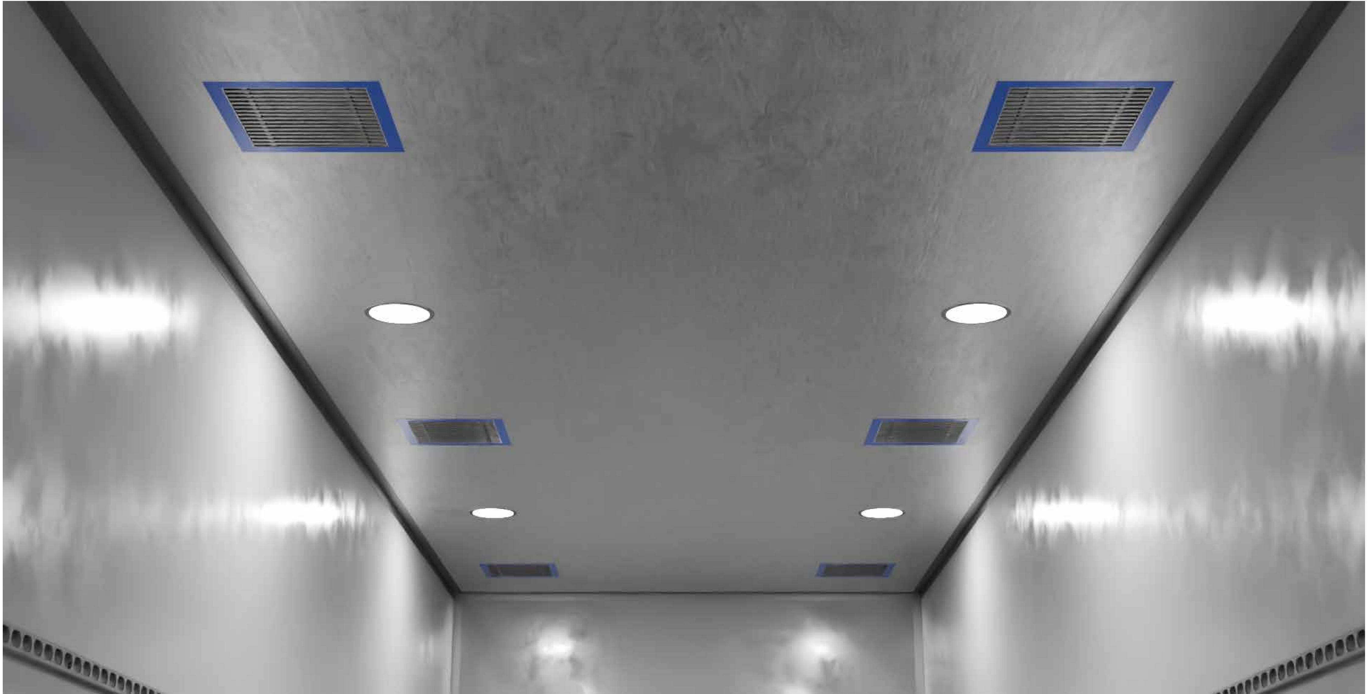
Kuva 62. Korin katossa sijaitsee kuusi puhallinsuutinta sekä neljä valoa. Nämä mahdollistavat tasaisen ilman puhaltamisen sekä riittävän valaistuksen.
