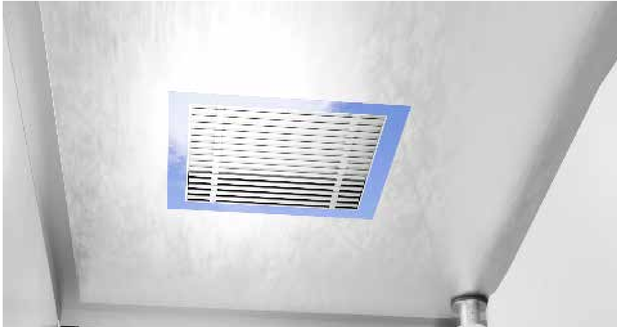
Kuva 58. Jakelukorin katossa sijaitsevat kylmäkoneen puhallinsuuttimet.
