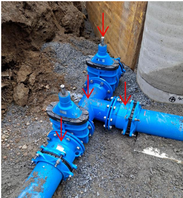
Kuva 28. Venttiilien mittauspisteitä (Infra Kiri Oy 2024, muokattu).
