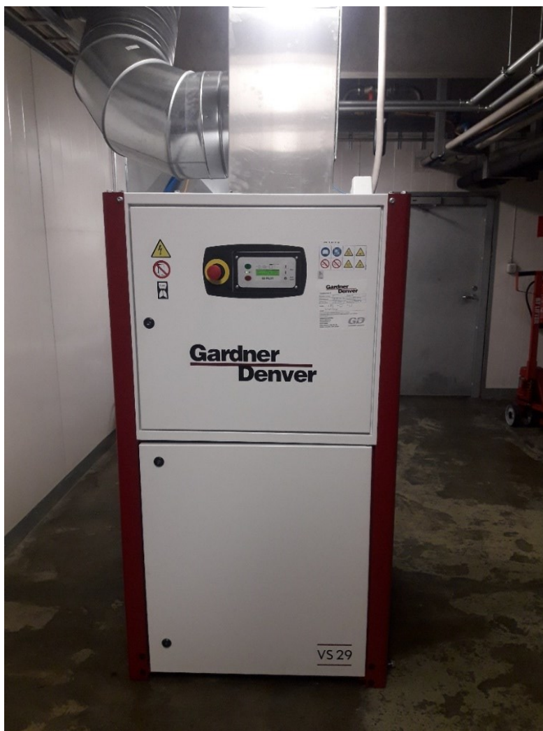
KUVA 22. Paikan päällä oleva ruuvikompressori omassa kopassaan. (Hyvärinen 2022.)
