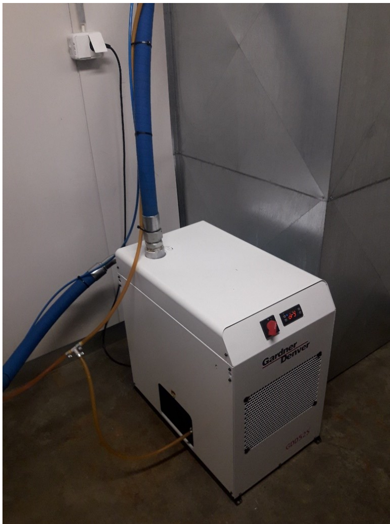
KUVA 23. Esimerkkinä kuva paikan päällä olevasta paineilmankuivaimesta joka on yhdistetty ruuvikompressoriin. (Hyvärinen 2022.)
