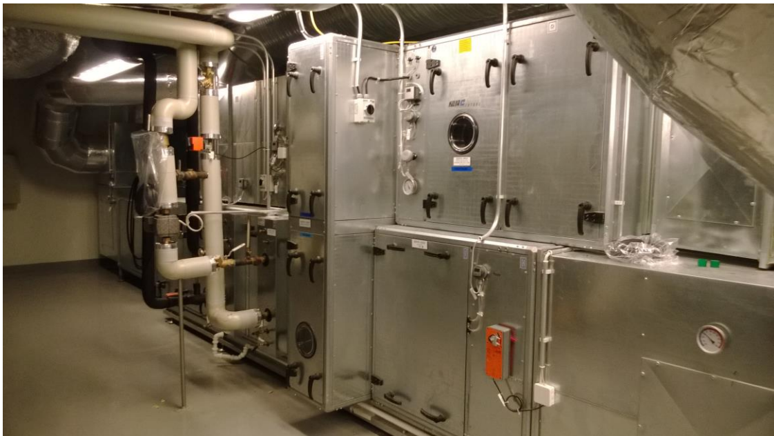
Kuva 3. Sito-talon ilmanvaihtokone numero 205.
