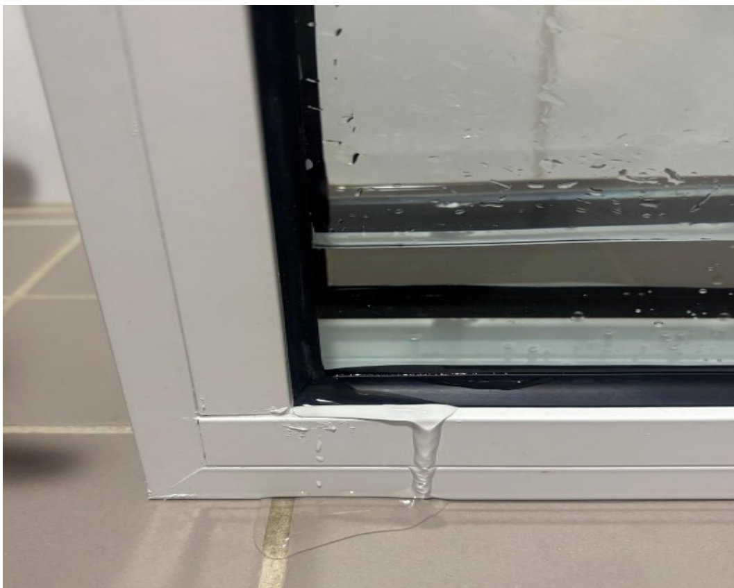
Kuva 17. Jälkiasennustiivisteidien liitoskohdan vuoto.
