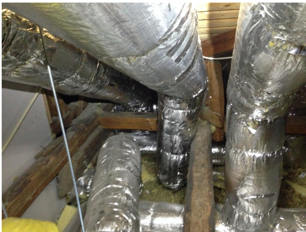
Kuva 22. Kuvassa risteilee ullakon iv-kanavistoa. (Kokkonen 2014)
