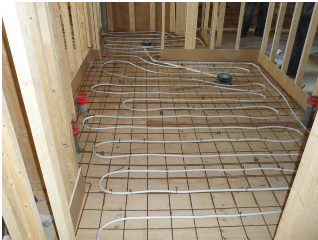
Kuva 16. Pesuhuoneen lattialämmitysputkitus (Kokkonen2014)
