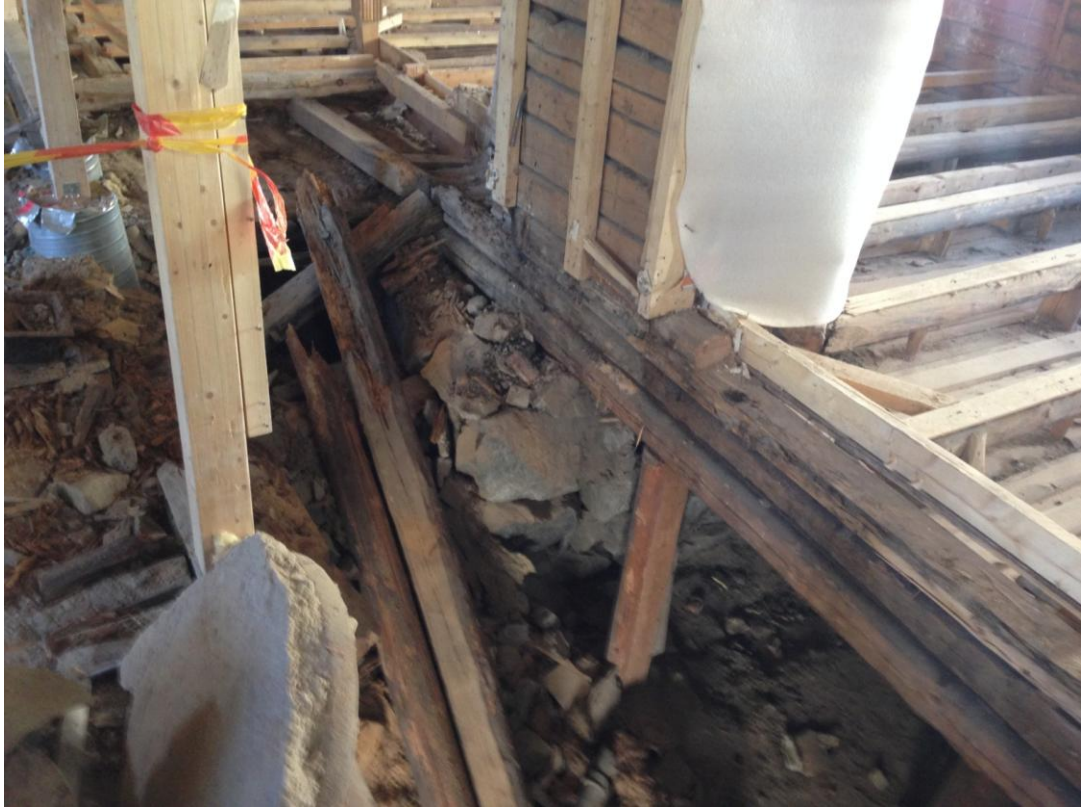
Kuva 17. Purettua, vahvistusta kaipaavaa alapohjarakennetta. (Kokkonen2014)
