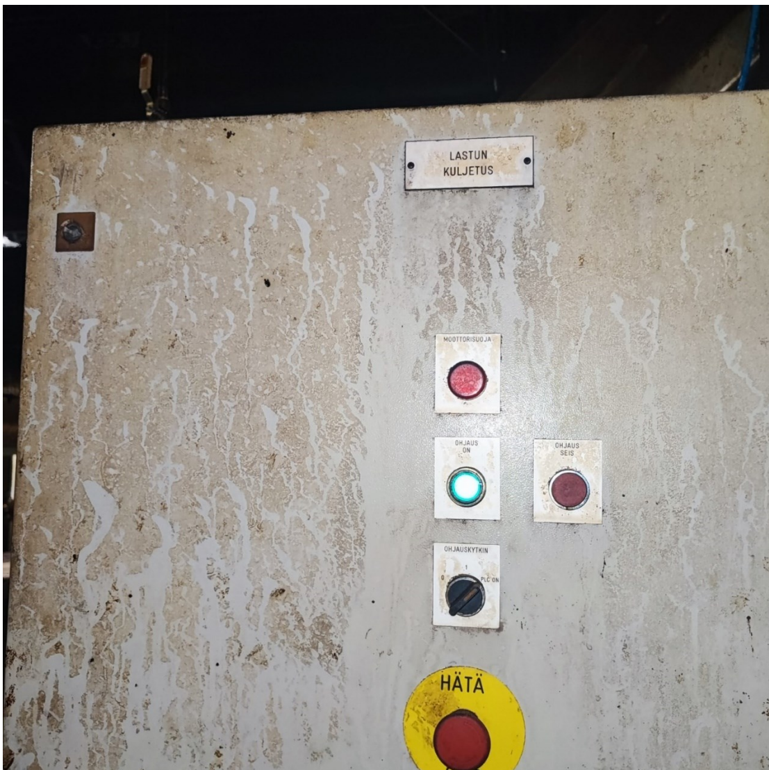
Kuva 2. Hakekuljettimen ohjauskeskuksen ohjauspaneeli.
