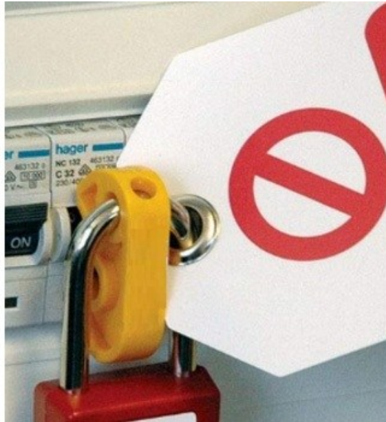
Kuva 8. Lukituslaitteella (totsilukolla) lukittu johdonsuojakatkaisija (Mittarit 2025)
