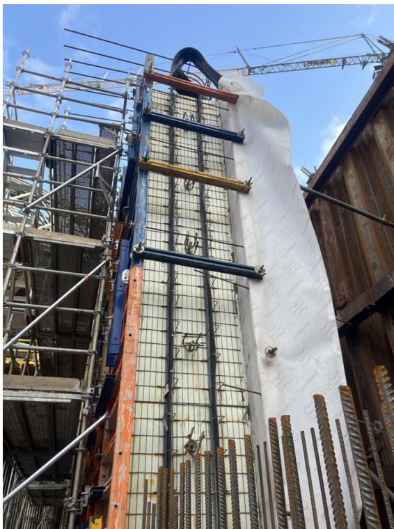
Kuva 19. T1-tunnelin seinän liikuntasaumat.
