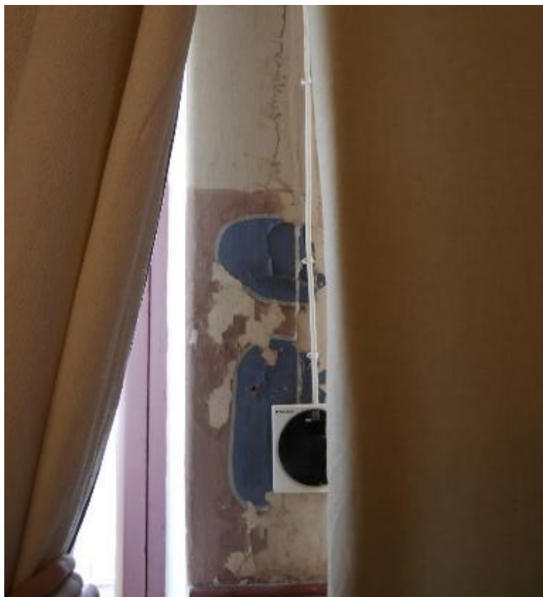
Iso neuvotteluhuone: Rapistunut maalipinta ja vesivaurio
