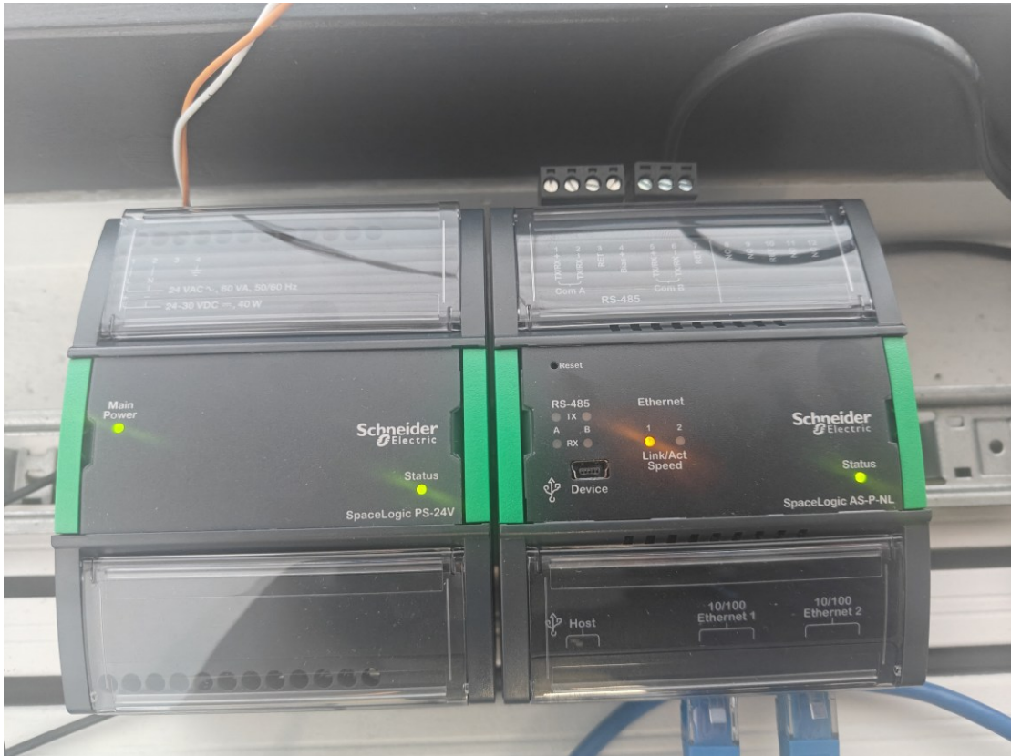
Kuva 4. Automaatiojärjestelmän äly ja tehrolähde kiinnitetään toisiinsa sekä DIN-kiskoon erillisten pohjalevyjen avulla, joten laitteiden irrottaminen on helppoa.
