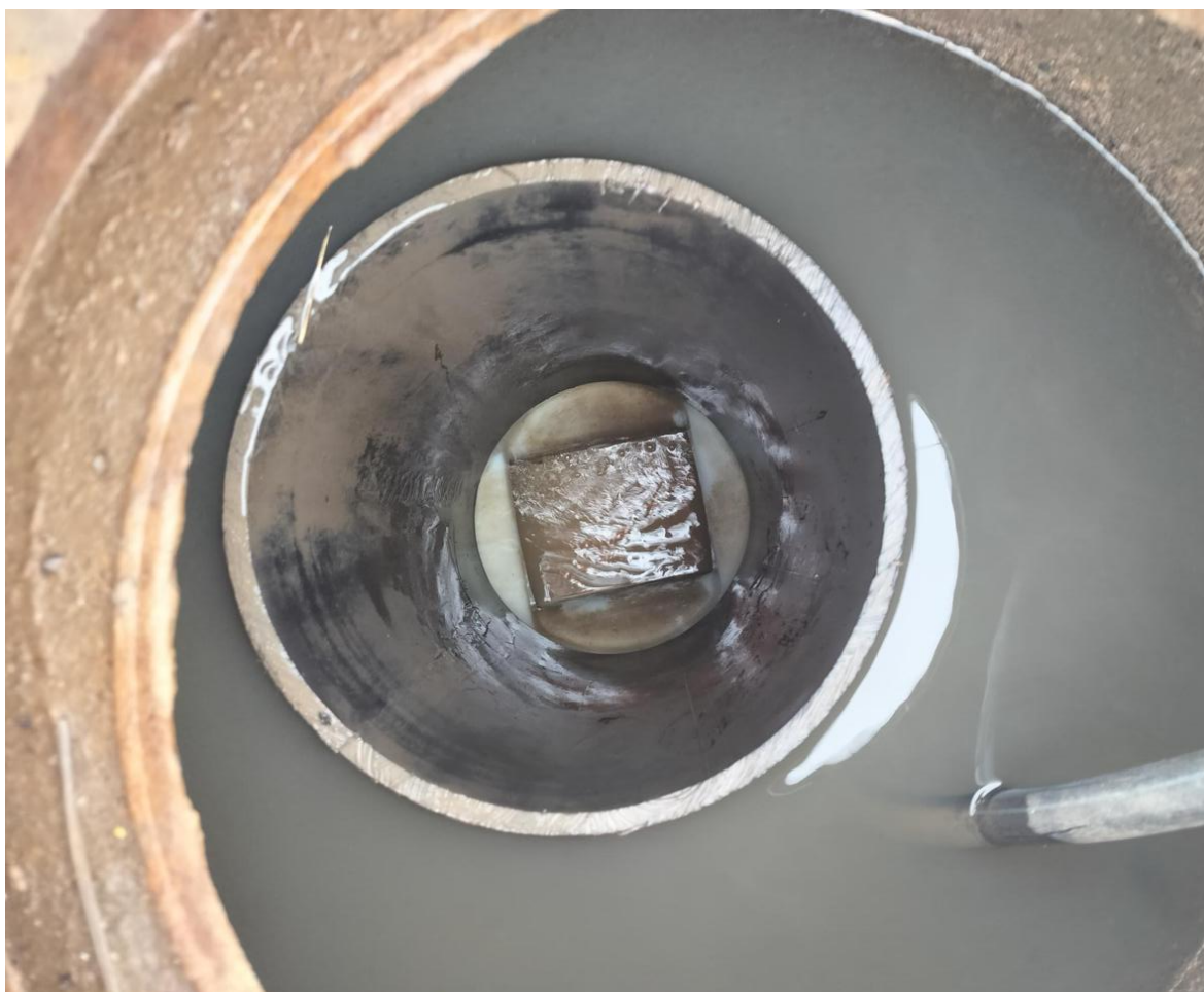
Kuva 9. Pintavesien johtuminen jätevesikaivoon (Sami Hellsten)
