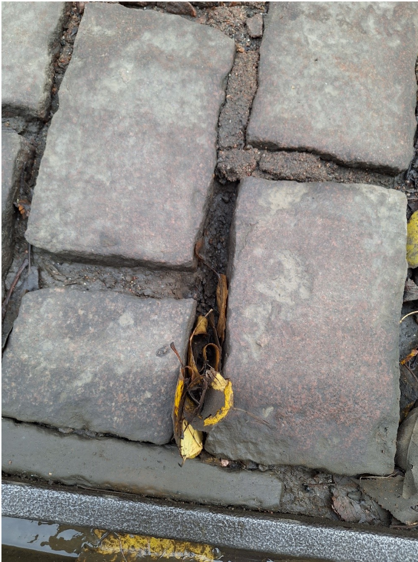
Kuva 18 Epoksikvartsihiekkasauman valahtaminen nupukivien väliin
