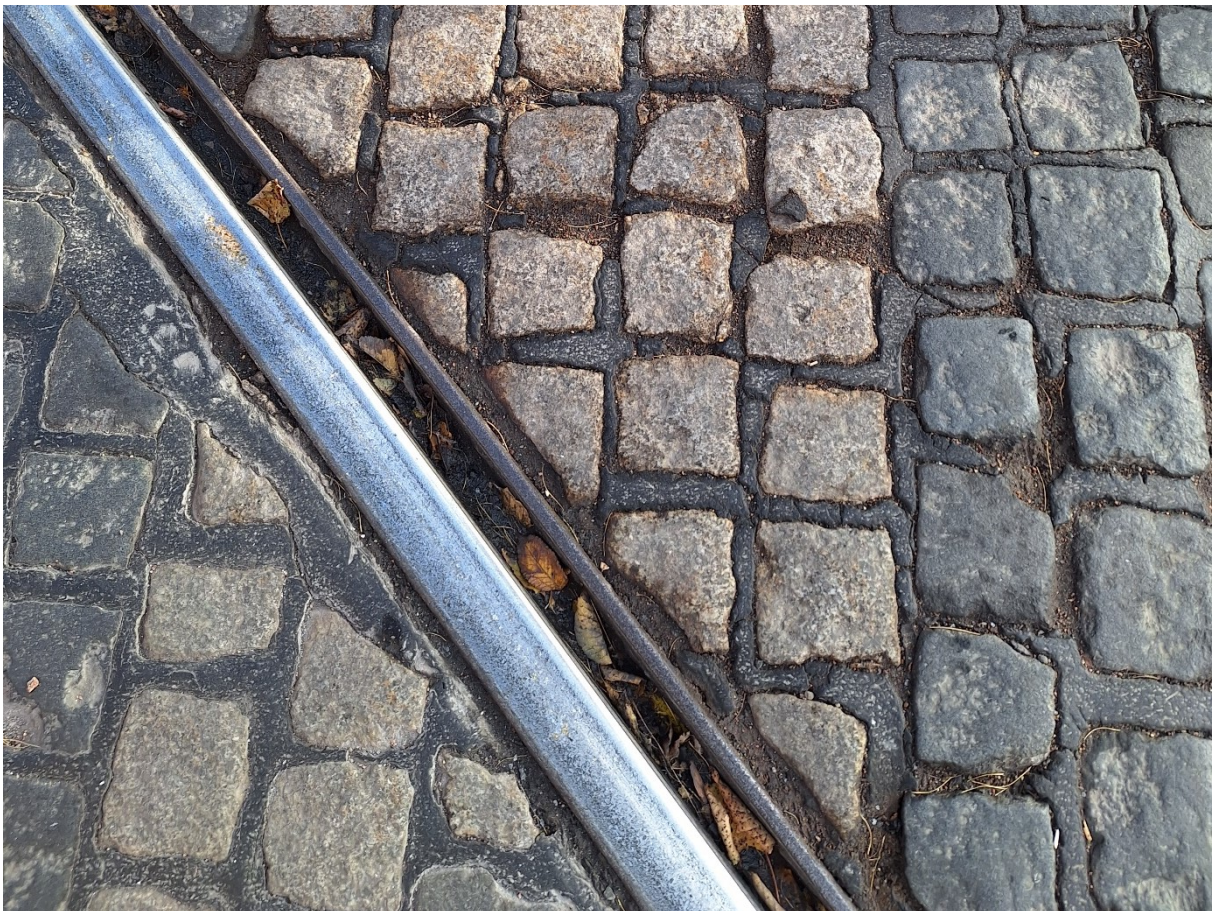
Kuva 9 Bitumisauma irtoillut paloina Tehtaankadulla
