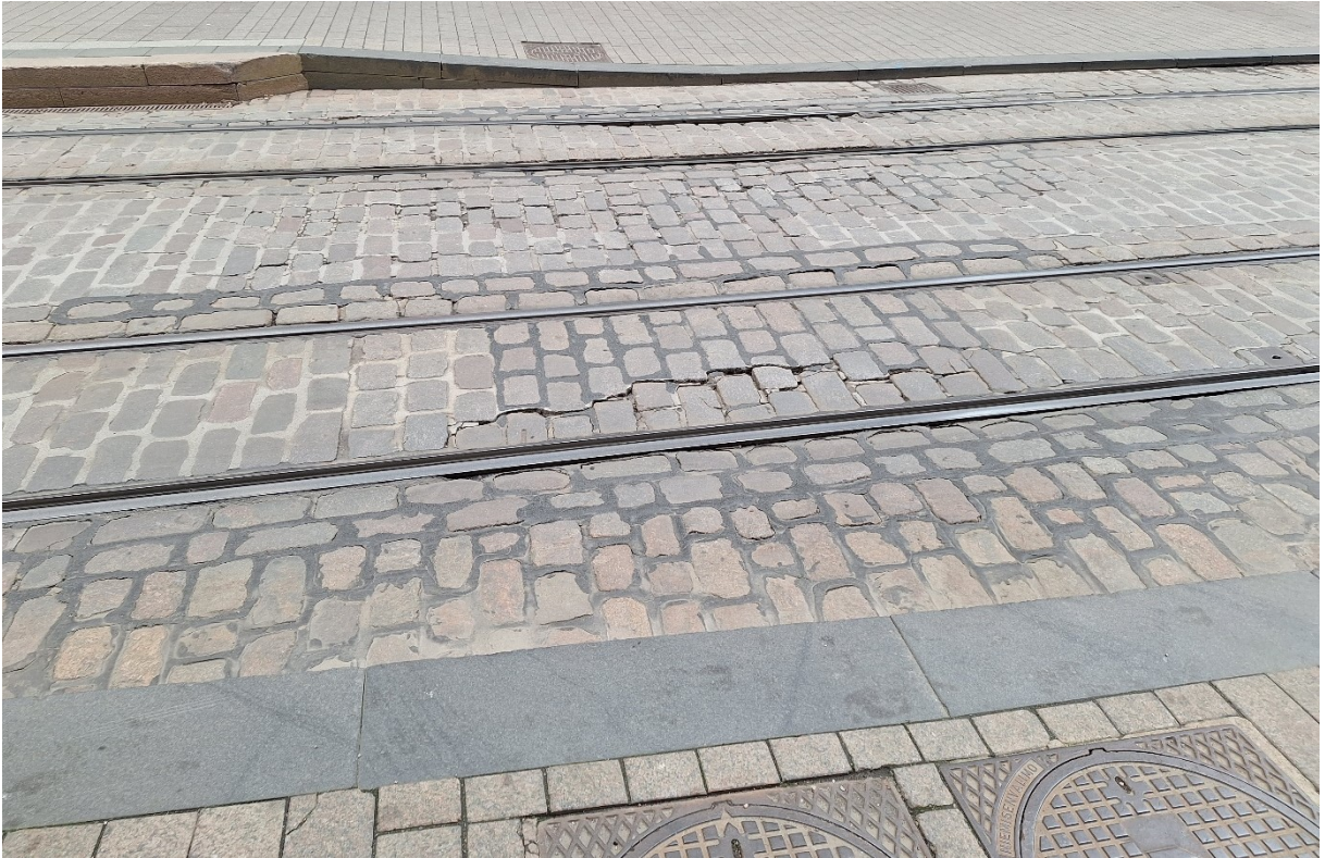
Kuva 22 Aleksanterinkadun nupukivien painuminen
