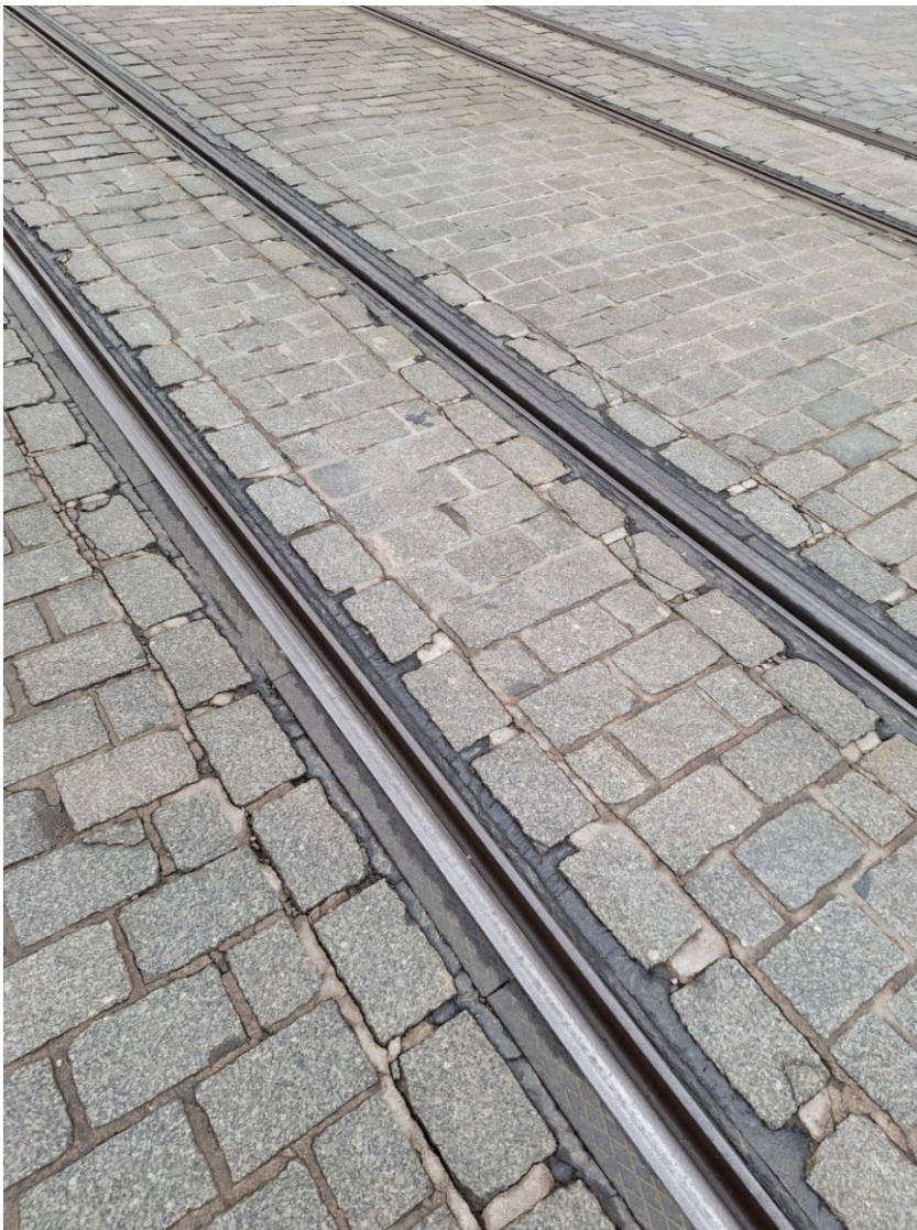
Kuva 19 Leonkadun nupukivien ja betonisaumojen murtumat
