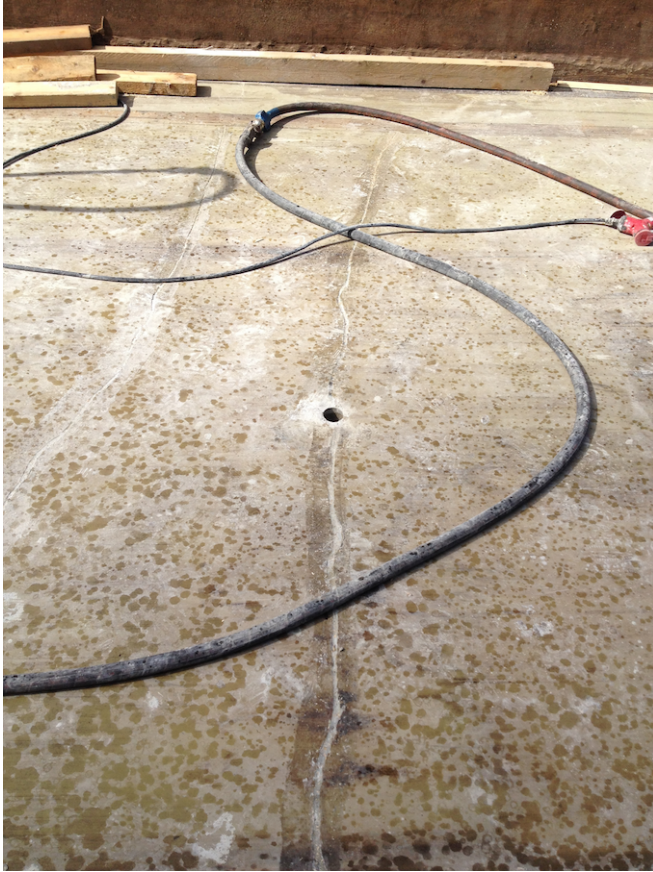
Kuva 13. Epoksilla täytettyjä poikittaisia halkeamia altaan pohjassa.
