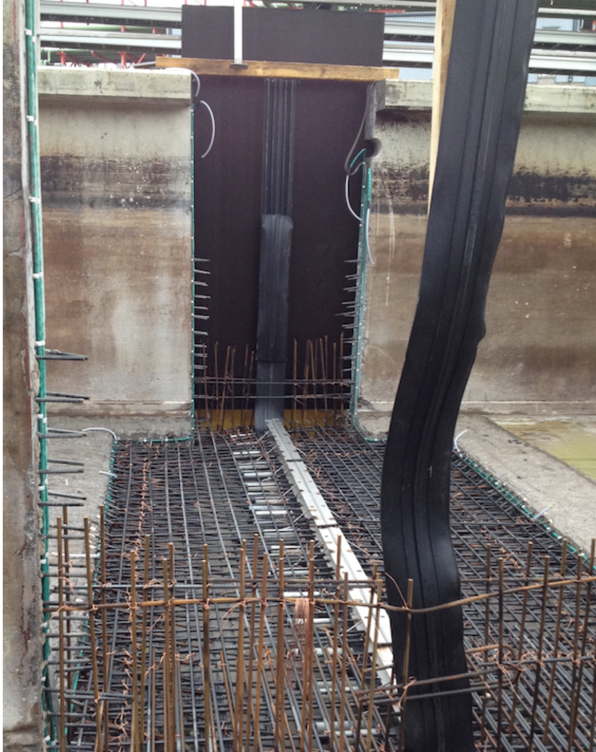
Kuva 6. Altaan pohjan liikuntasauma valukunnossa.
