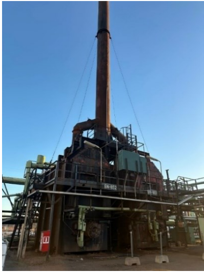
Kuva 3. Vanha lämmönsiirtoöljyn lämmitysyksikkö BA-851 ja BA-852.
