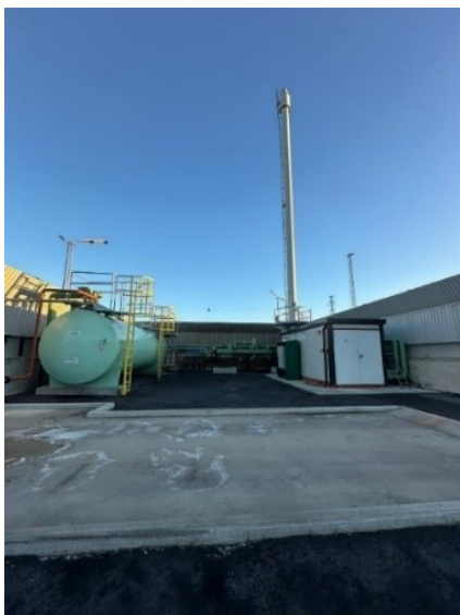
Kuva 4. Bitumialueen uusi lämmönsiirtoöljyn lämmitysyksikkö.
