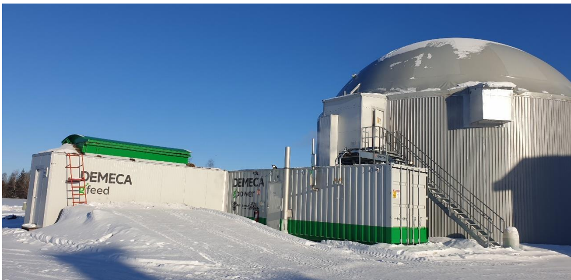
Kuva 1. Biokaasulaitos. Vasemmalta oikealle rakennukset: Lisäsyöttösuoja, reaktori ja laitoksen ohjauskeskus, lietesäiliö.
