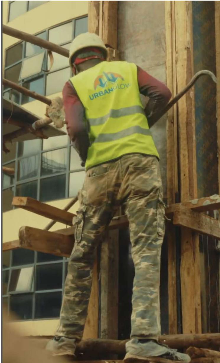
Kuva 6. Työntekijä Finsbury Heights -rakennustyömaalla Nairobissa. Kuvasta näkyy, kuinka työmailla turvallisuus- ja valvontakäytännöt voivat olla puutteellisia: työntekijä seisoo korkealla bambu- ja puutelineellä ilman turvavaljaita tai suojakenkiä. Tällaiset tilanteet korostavat tarvetta parantaa työmaavalvontaa ja turvallisuuskulttuuria rakennusalalla (Urban Glow Real Estate Ltd, 2025).
