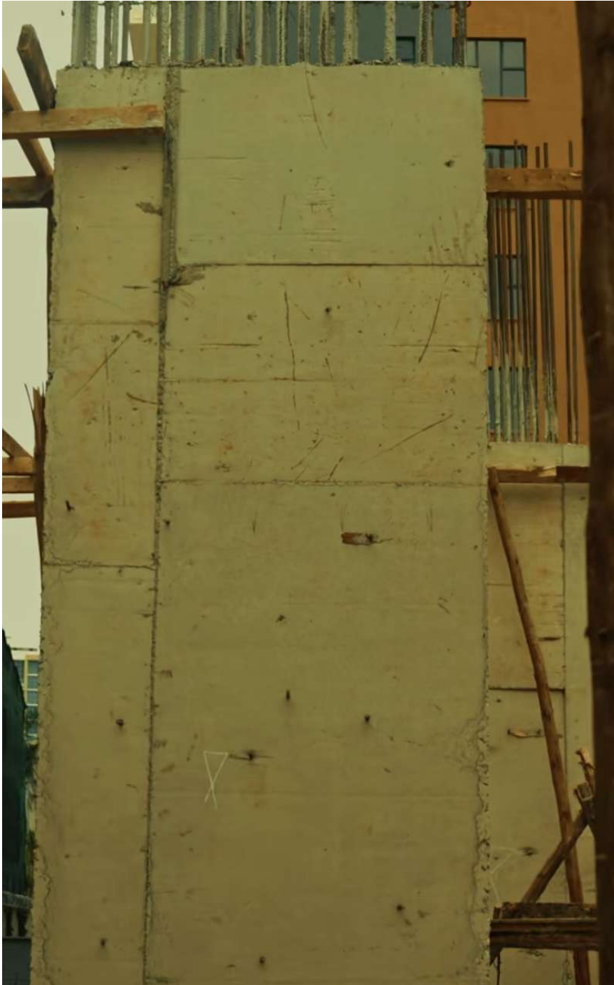
Kuva 7. Valmiita betonirakenteita Finsbury Heights -työmaalla. Kuvassa näkyy muottipintojen jälkiä ja epätasaisuuksia, jotka kertovat käsityövaltaisesta betonoinnista ja laadunvalvonnan haasteista (Urban Glow Real Estate Ltd, 2025).
