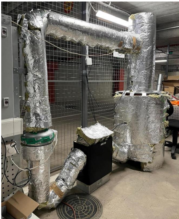
Kuva 14. Valmis LTO järjestelmä.
