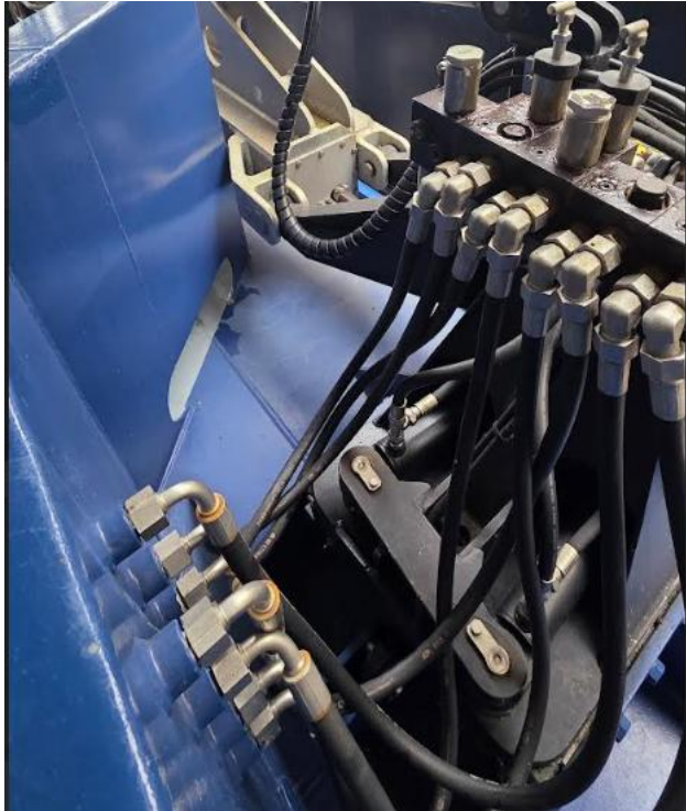
Kuva 4. Kuvassa putket on vedetty rakenteen läpi ja jatkettu letkuilla mahdollisen tilanpuutteen vuoksi. Kuva on otettu Polaris-jäänmurtajalta.
