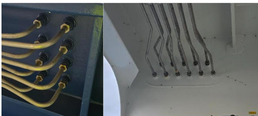
Kuva 10. Putkien läpiviennit jäänmurtaja Polariksella. Tässä kuvassa nähdään, että putket on reititetty samasta kohdasta, mikä helpottaa niiden läpivientiä.
