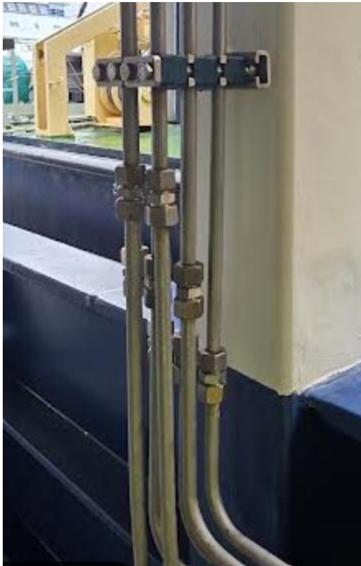
Kuva 3. Kuvassa näkyy hydraulikkaputkien liitoskohdat. Kuva on otettu Polaris-jäänmurtajalta.
