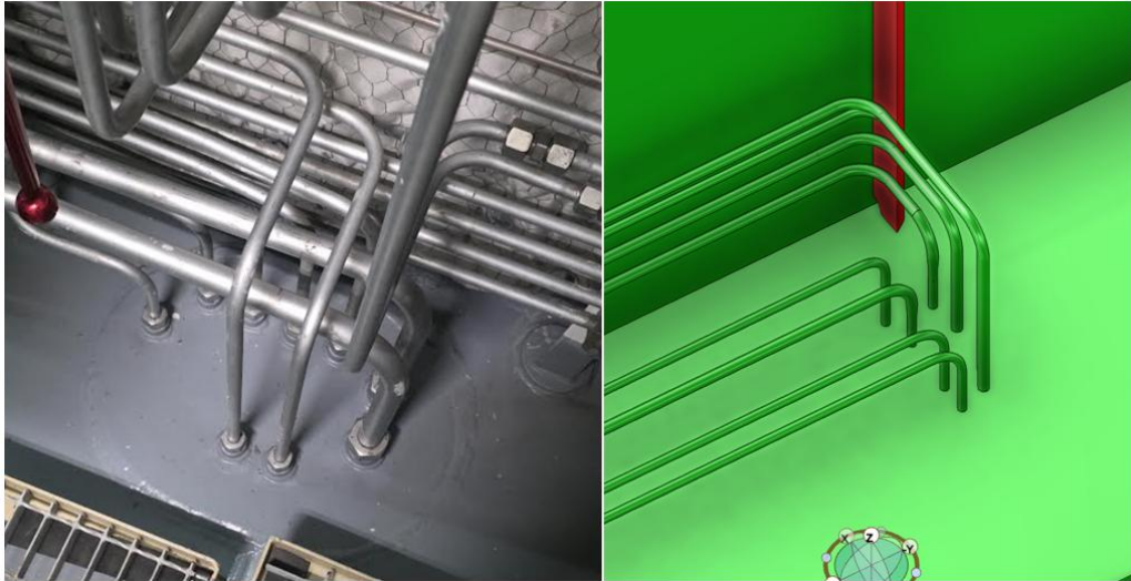
Kuva 14. Vasemmanpuoleisessa kuvassa päällimmäiset putket risteävät turhaan muiden putkien yli. Tämä hankaloittaa mm. huoltoa. Mallintaessa putket 3D-malliin voidaan välttyä turhalta putkien risteämiseltä.
