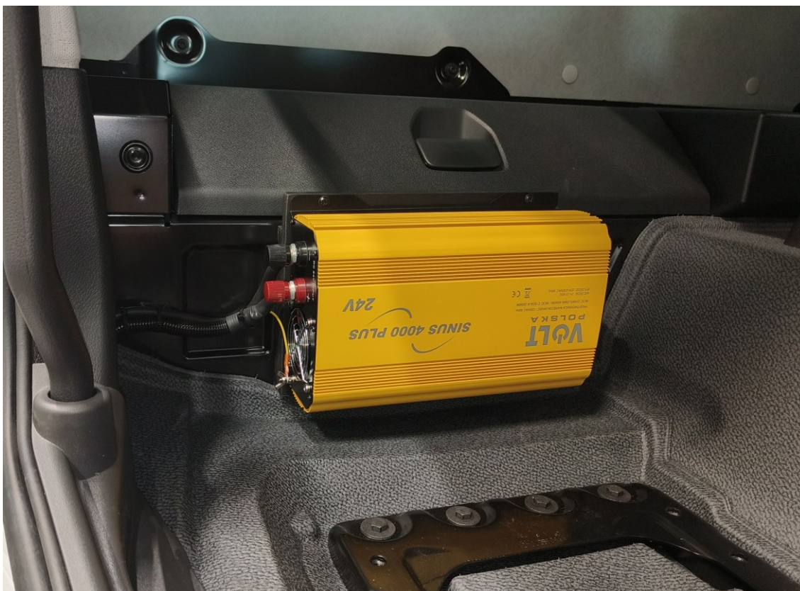
Kuva 4. Sinus 4000 Plus 24V vaihtosuuntaaja asennettuna apukuljettajan istuimen taakse työkaluarkun kylkeen.
