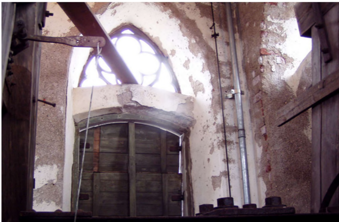
KUVA 90. Kellotornin sisäseinät olivat pahasti pakkasrapautuneet vuoden 2005 kuntotutkimuksen aikana (Kuva: Maja & Koskinen 2005).
