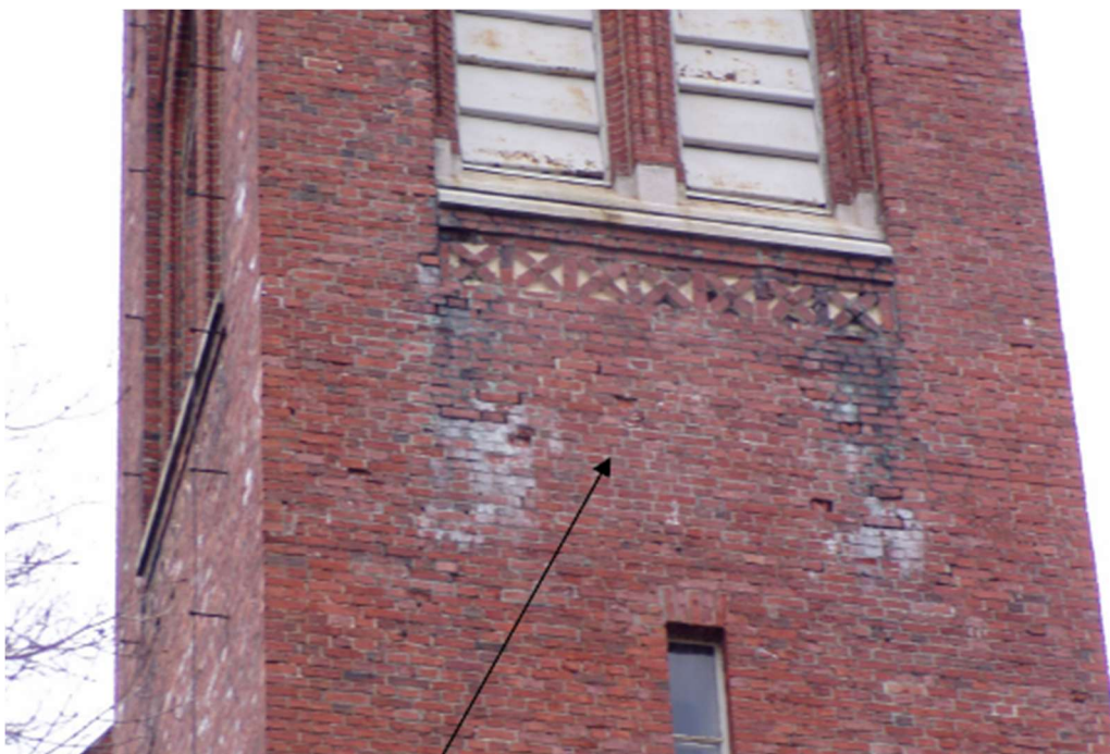
KUVA 89. Kellotornin julkisivutiilien säävaurioita vuoden 2005 kuntotutkimuksen aikana (Kuva: Maja & Koskinen 2005).
